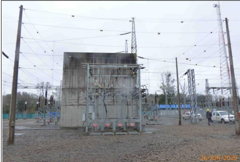
Fotografía 3: Cerco perimetral al parrón de 23 kV
