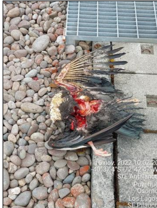
Fotografía 1: Ave que acorta distancia de aislación en desconectador 89Y41(3)
