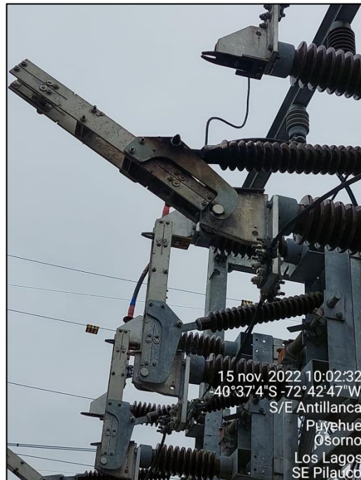
Fotografía 2: Evidencia de arco en desconectador 89Y41(3)
