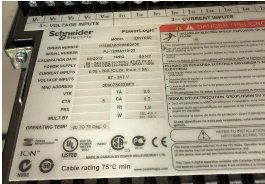
Figura 9-5 – Datos de placa medidor de potencia bruta y factor de potencia - Unidad U1
