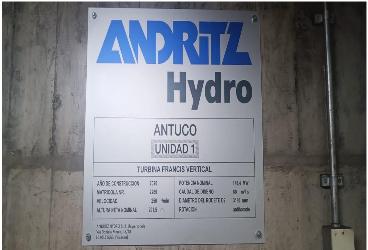
Figura 4.8 – Placa turbina Unidad 1
