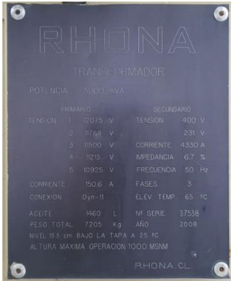
Figura 8.15: Placa del transformador de servicios auxiliares
