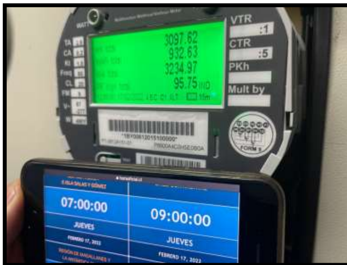
Fig. 1: Toma de dato en el medidor de facturación de Central El Totoral.
