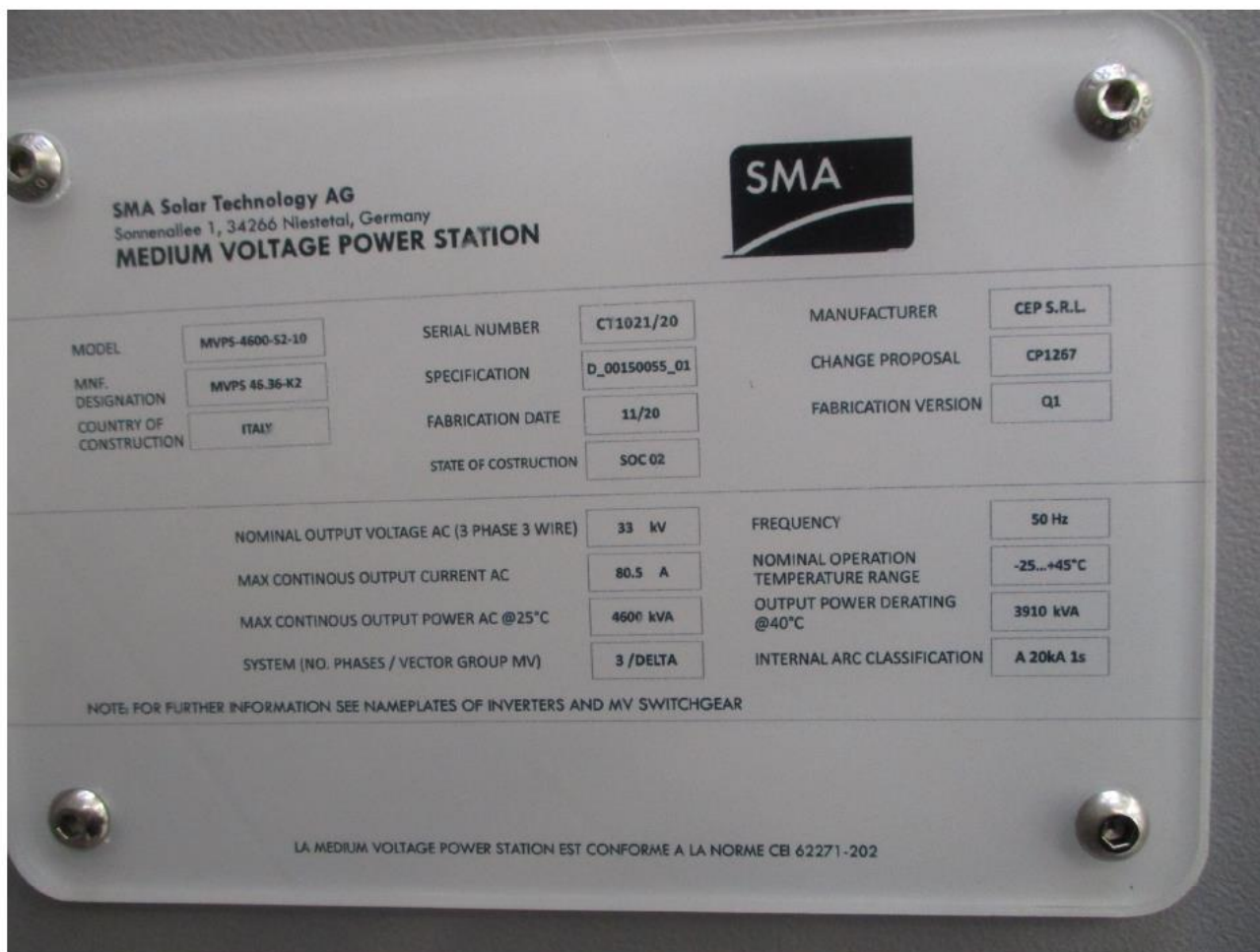
Figura 6.1: Placa de datos Centro de transformación tipo MVPS-4600 S2- PFV Diego de Almagro Sur.
