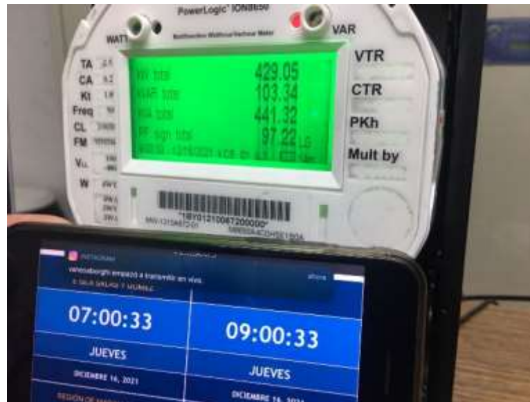
Fig. 2: Medidor de energía provisorio.
