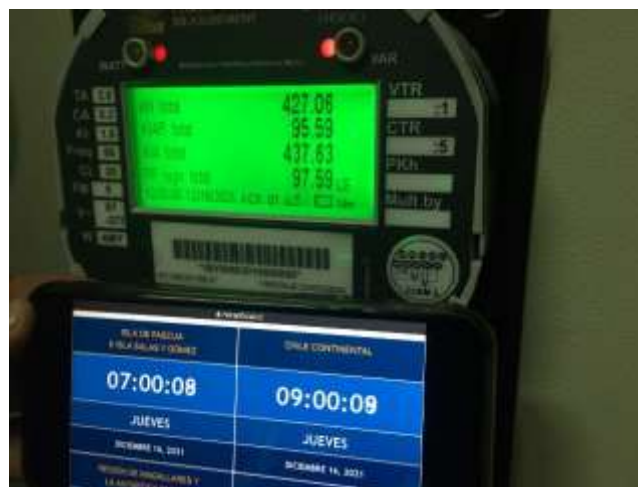
Fig. 1: Medidor de energía de facturación.
