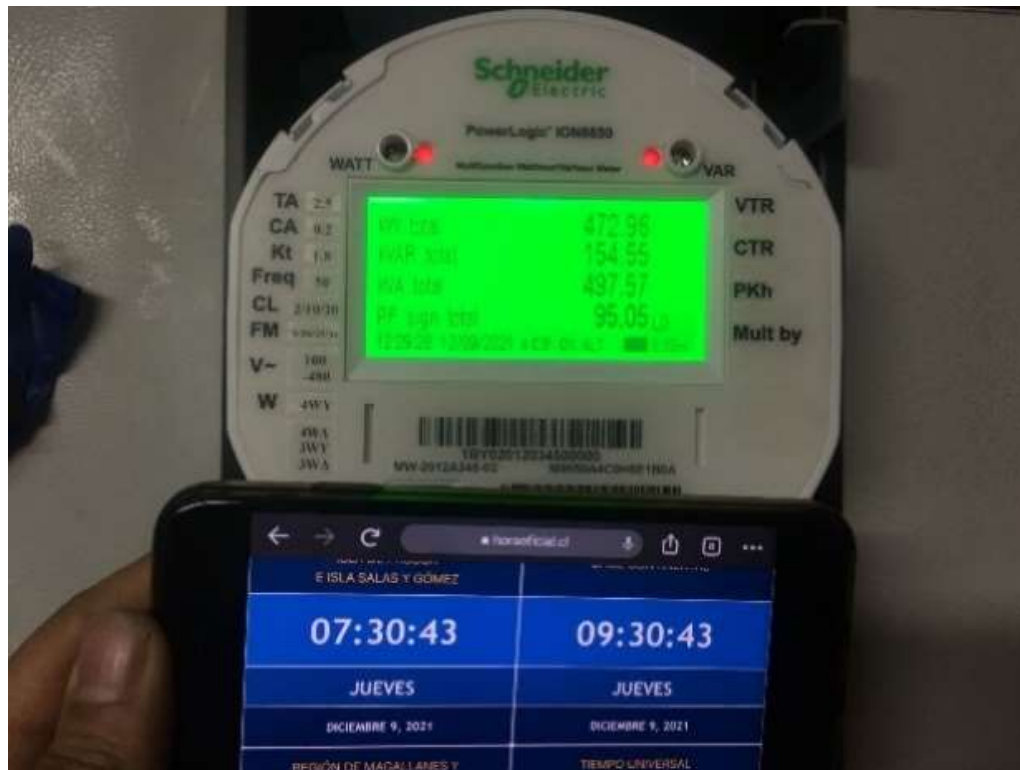
Fig. 2: Medidor de energía de facturación.
