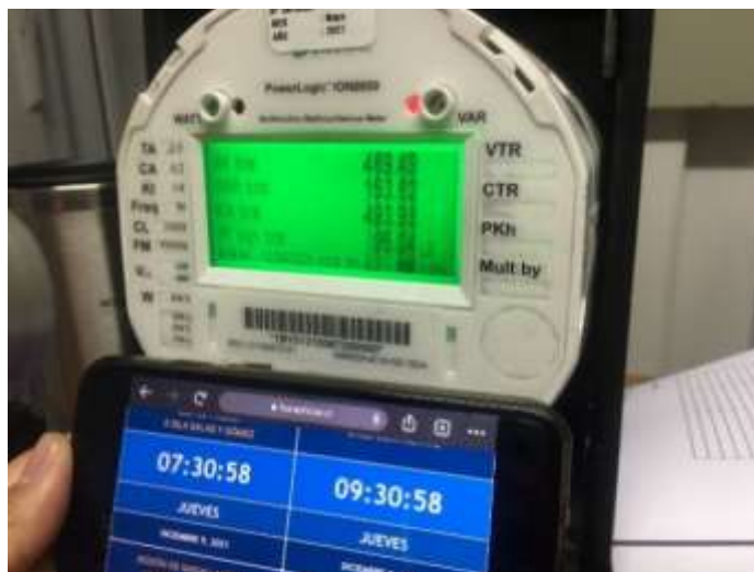
Fig. 1: Medidor de energía provisorio.
