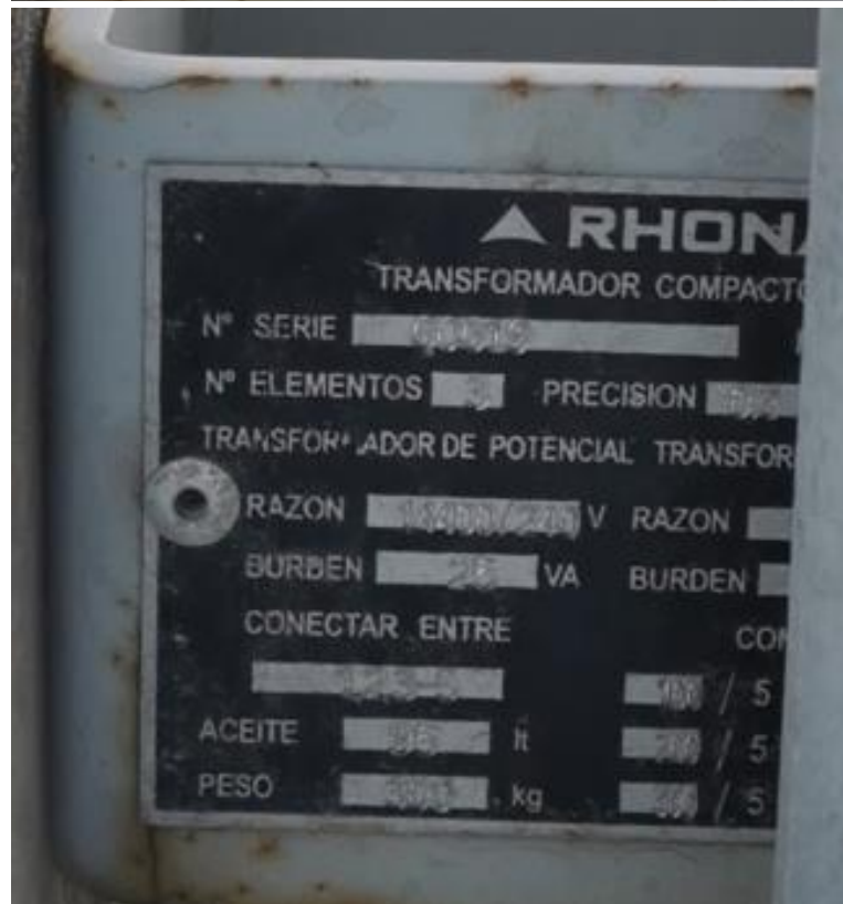
Figura 9-15 – Datos de placa del equipo compacto de medida para la medición de potencia neta
