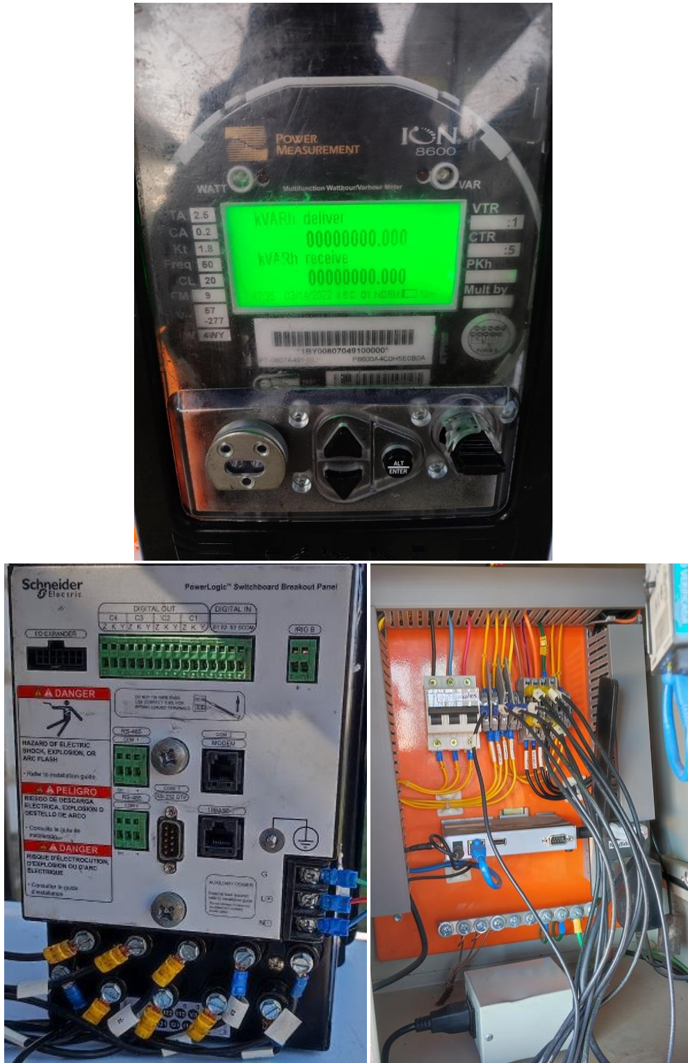
Figura 9-31 – Medidor de potencia neta
