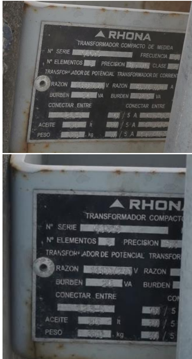
Figura 9-26 – Datos de placa del equipo compacto de medida para la medición de potencia neta
