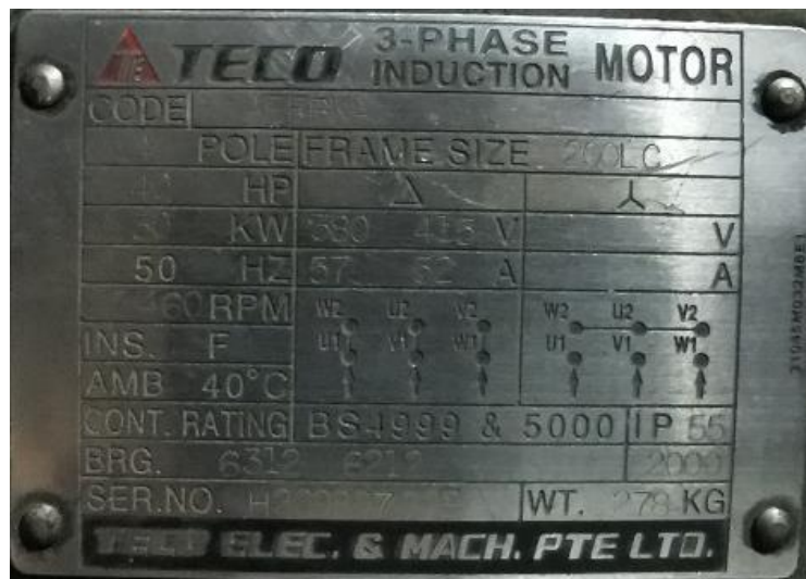
Figura 9-12 – Placa del motor del ventilador
