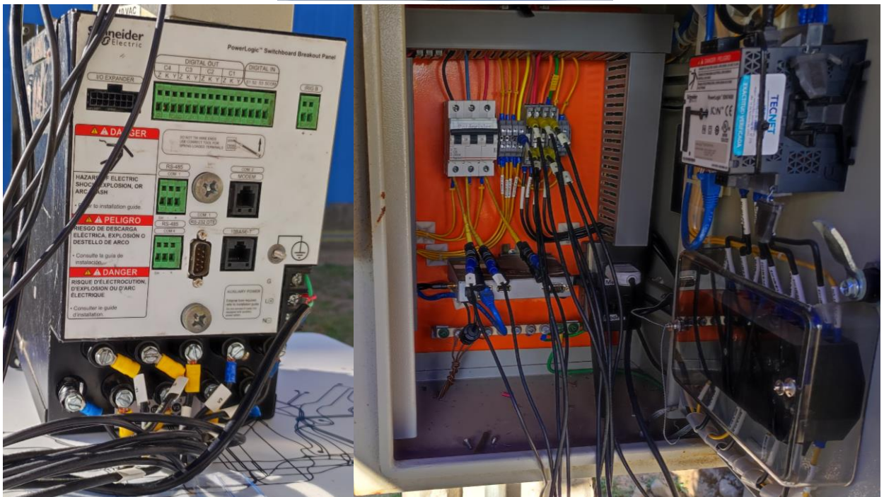
Figura 9-44 – Medidor de potencia neta
