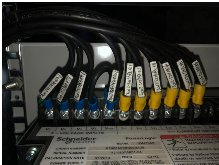
Figura 9-15 – Bornes medidor de potencia neta – Circuito 2
