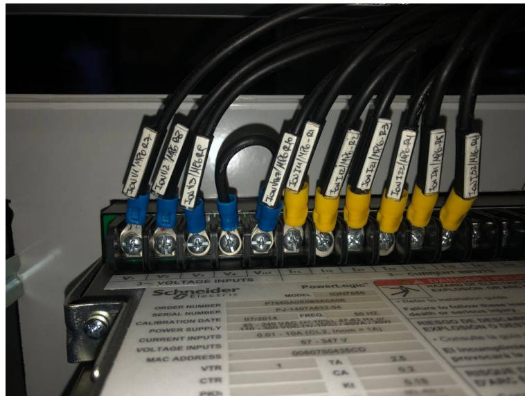
Figura 9-14 – Bornes medidor de potencia neta – Circuito 1
