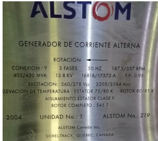
Figura 4-4 – Datos de placa del generador U1
