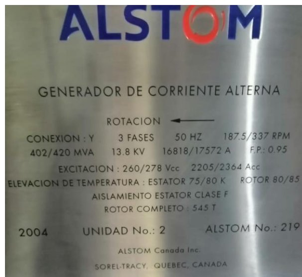
Figura 4-5 – Datos de placa del generador U2
