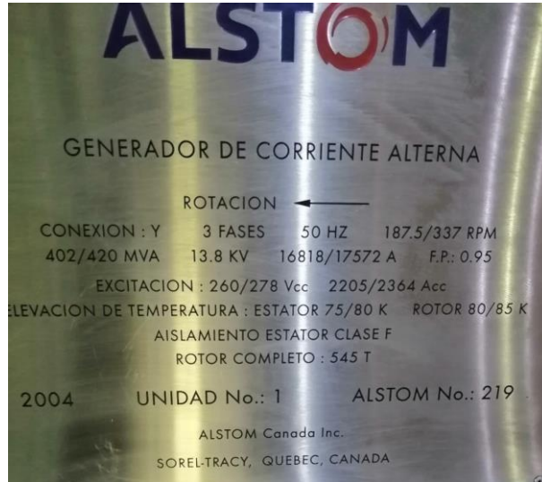
Figura 4-4 – Datos de placa del generador U1
