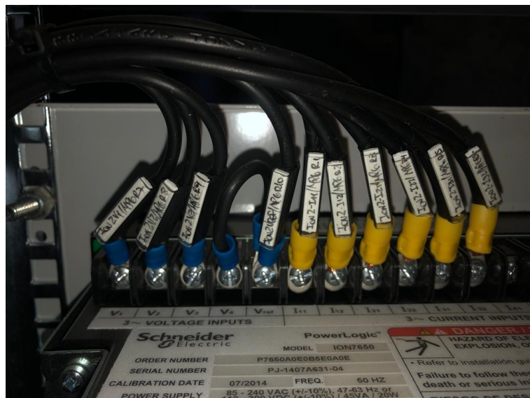
Figura 9-13 – Bornes medidor de potencia neta – Circuito 2
