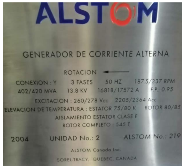
Figura 4-5 – Datos de placa del generador U2
