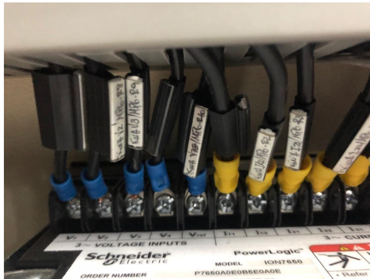
Figura 9-8 – Bornes medidor de potencia bruta – Unidad 1
