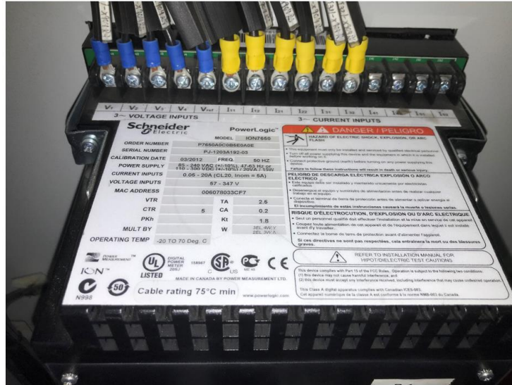
MEDIDOR ENERGIA BRUTA UNIDAD 2
