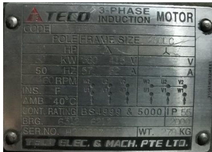
Figura 9.12 – Placa del motor del ventilador
