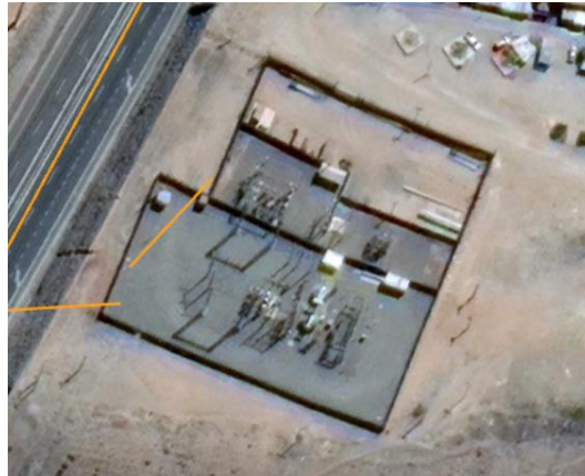
Ilustración 22 Vista aérea S/E Vallenar.
