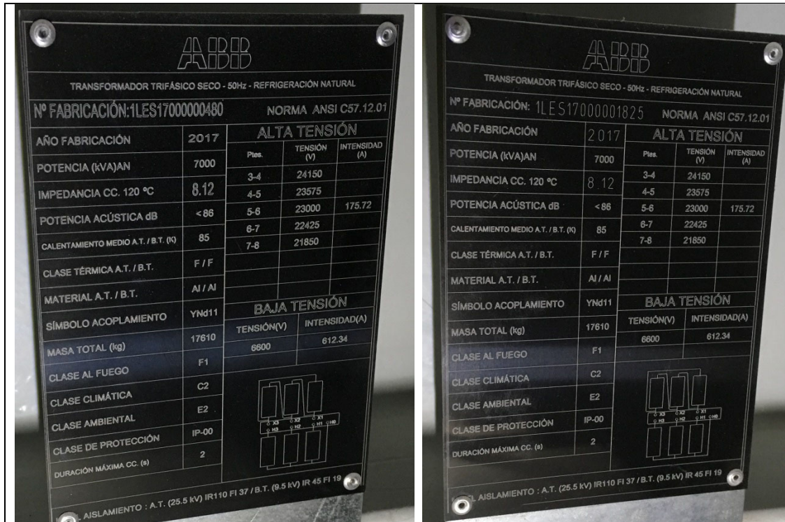
Fotografía 3 Placa Características de los Transformadores de Poder - ABB
