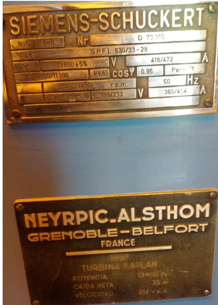
Figura 4.4 – Datos de placa de generador y turbina
