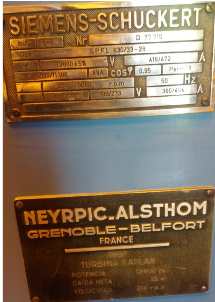
Figura 9.1 – Datos de placa de generador y turbina
