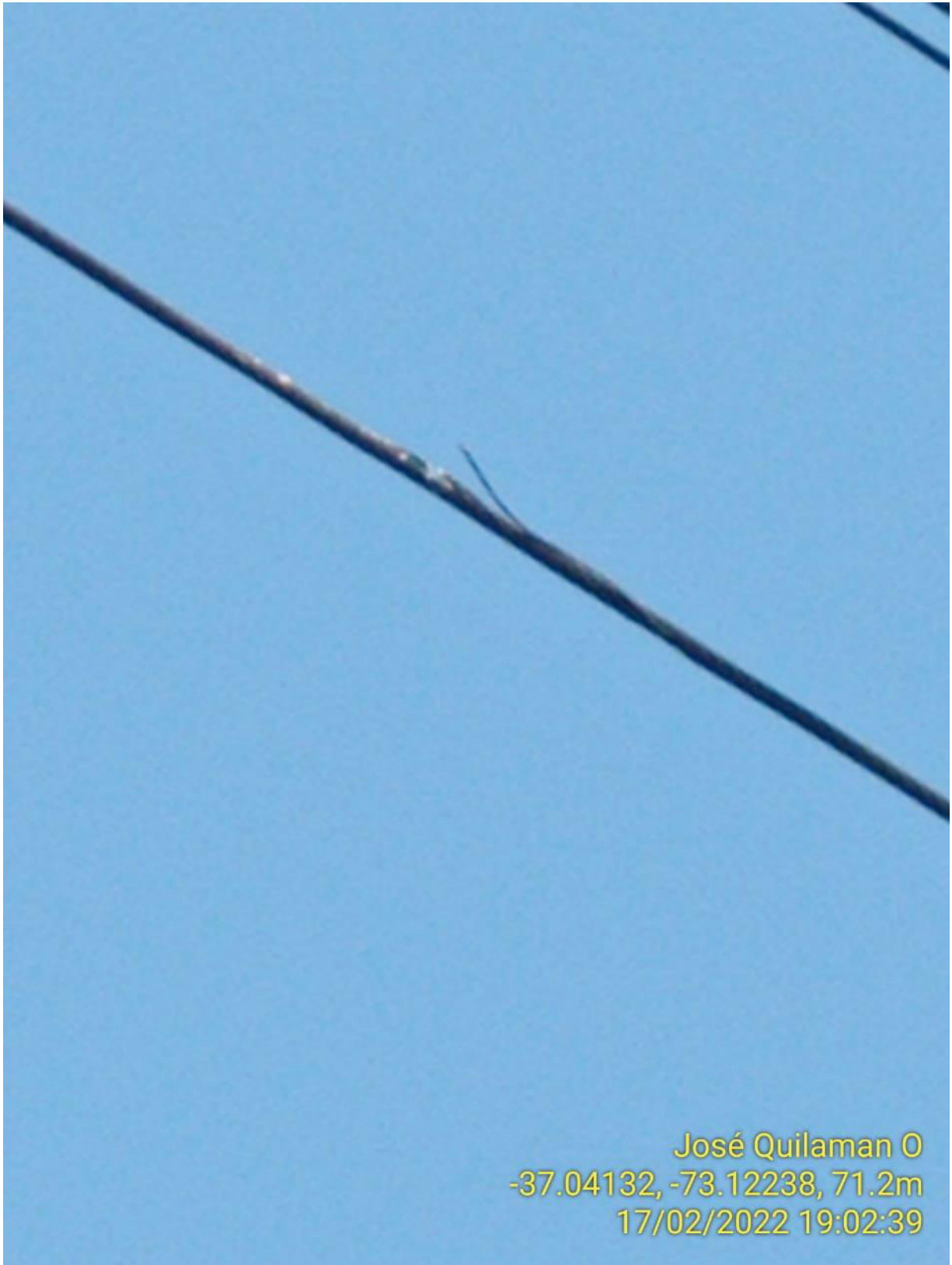
Fotografía N° 4: Registro de las 2 hebras cortadas producto del árbol fuera de franja talado por terceros entre estructura 25 y 26 de la línea LT El Manco-Andalicán N°2.
