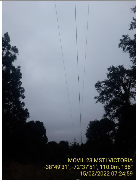
Vano E309 – E310
