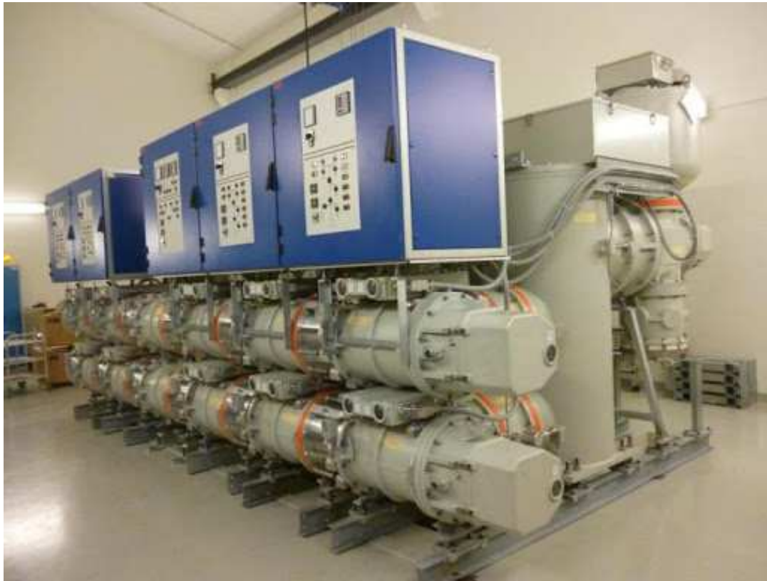
Ilustración 3-3 SS/EE tipo blindada (SF6)
