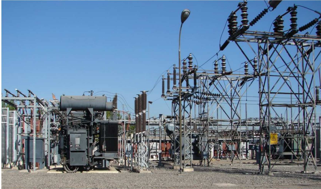
Ilustración 3-1 SS/EE tipo intemperie
