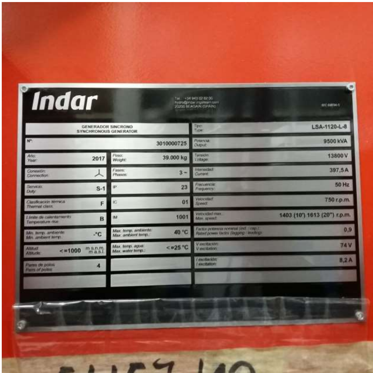
Figura 6: Placa de identificación Unidad Generador 1
