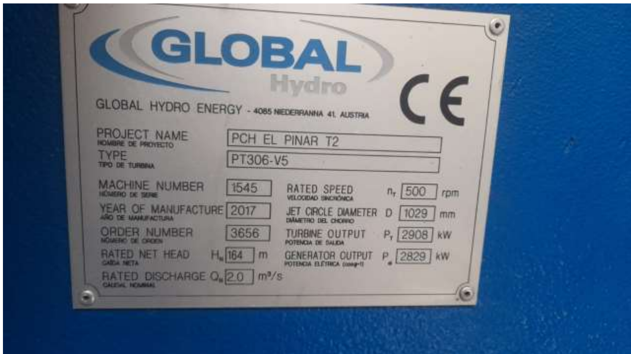
Figura 7: Placa de identificación Unidad Turbina 2 Modelo Pelton
