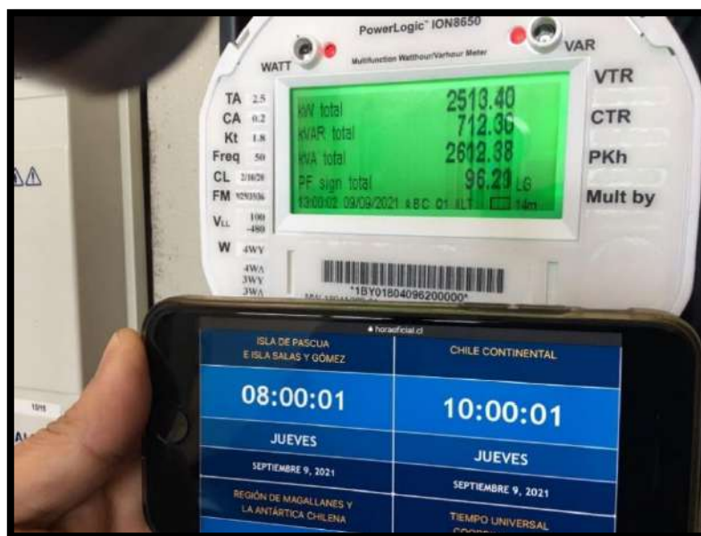
Fig. 1: Toma de dato en el medidor de facturación de Central Concón.
