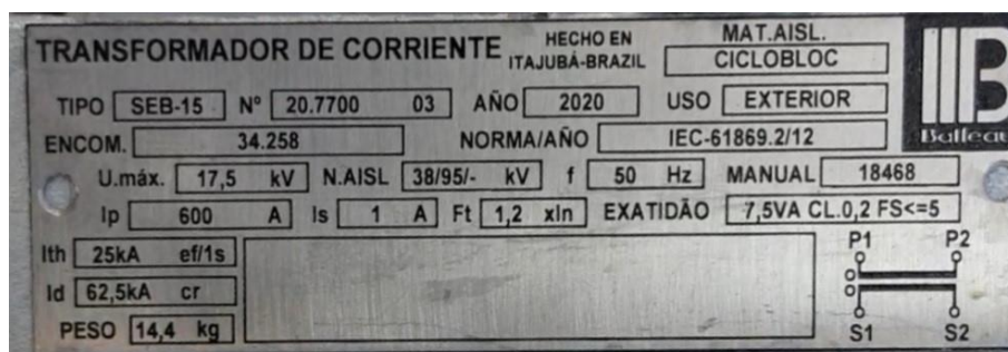
Figura 9.5 – Foto de placa transformador de corriente
