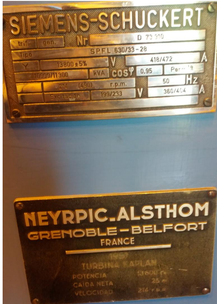
Figura 4.4 – Datos de placa de generador y turbina
