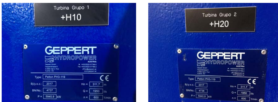
Fotografía 1 Placa Características de las Turbinas Pelton Eje Horizontal
