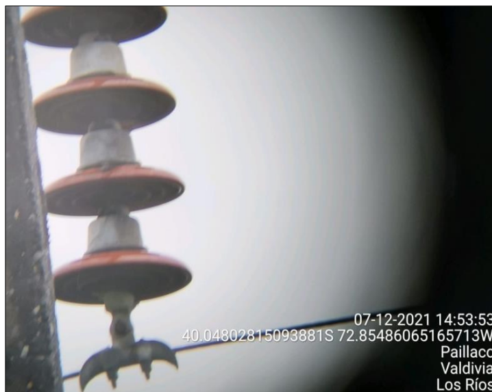
Fotografía N°2: Se observan señal de arco en la cadena de aislación.
