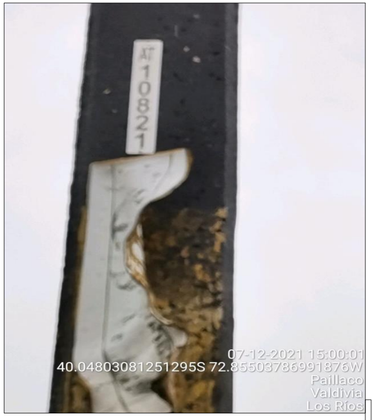
Fotografía 1 muestra descarga eléctrica en estructura AT 10821.
