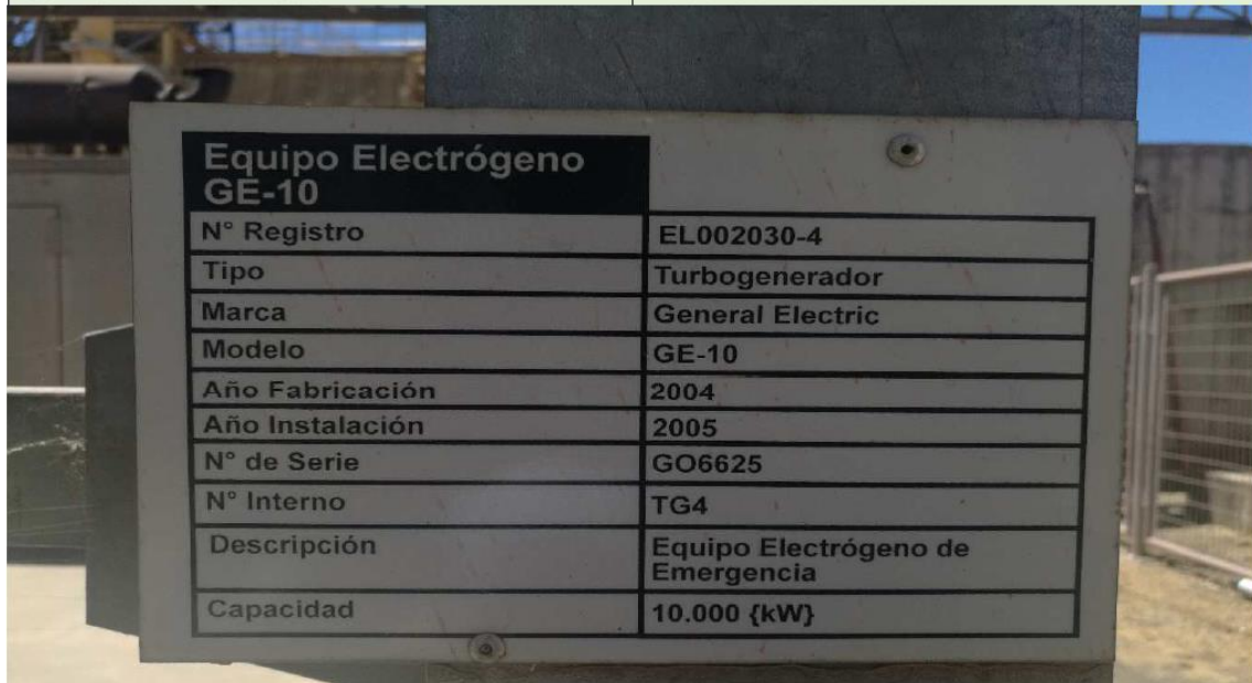
Figura 4.4 – Datos de placa de la turbina
