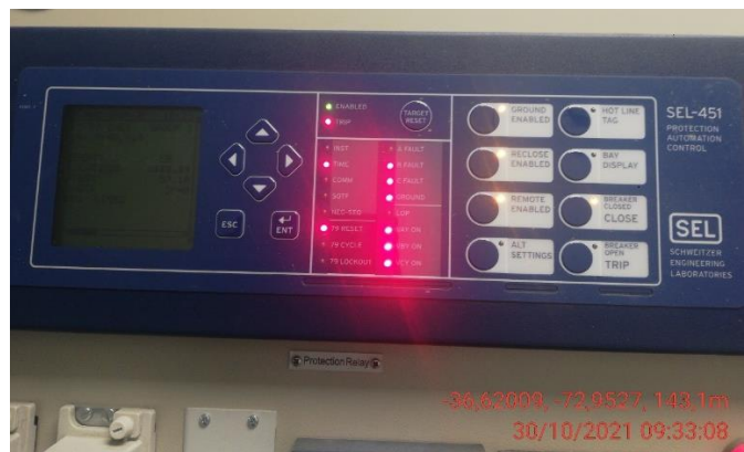
Fotografía N° 2: Registros de falla en relé de Alimentador Lirquén de S/E Mahns.
