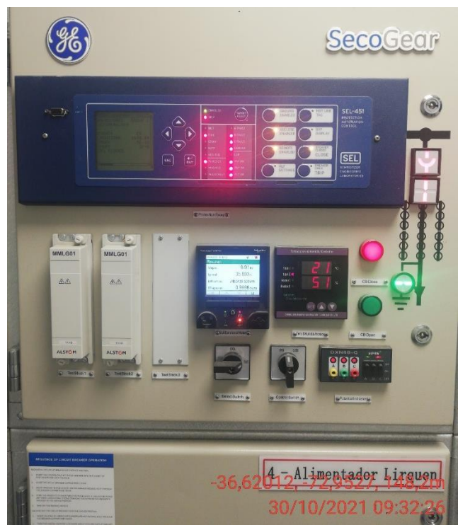
Fotografía N° 1: Registros de falla en relé de Alimentador Lirquén de S/E Mahns.
