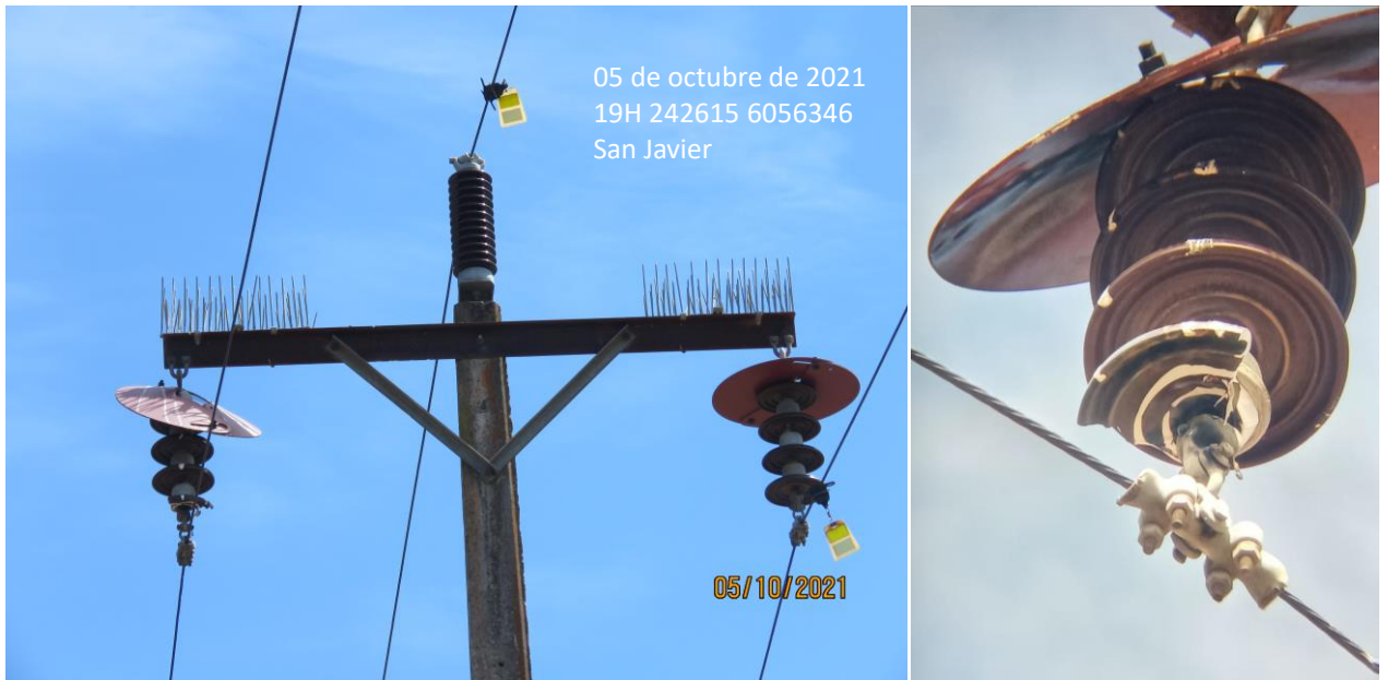
Figura A. 1: Registro fotográfico con fecha, hora y coordenadas UTM del punto de falla.
