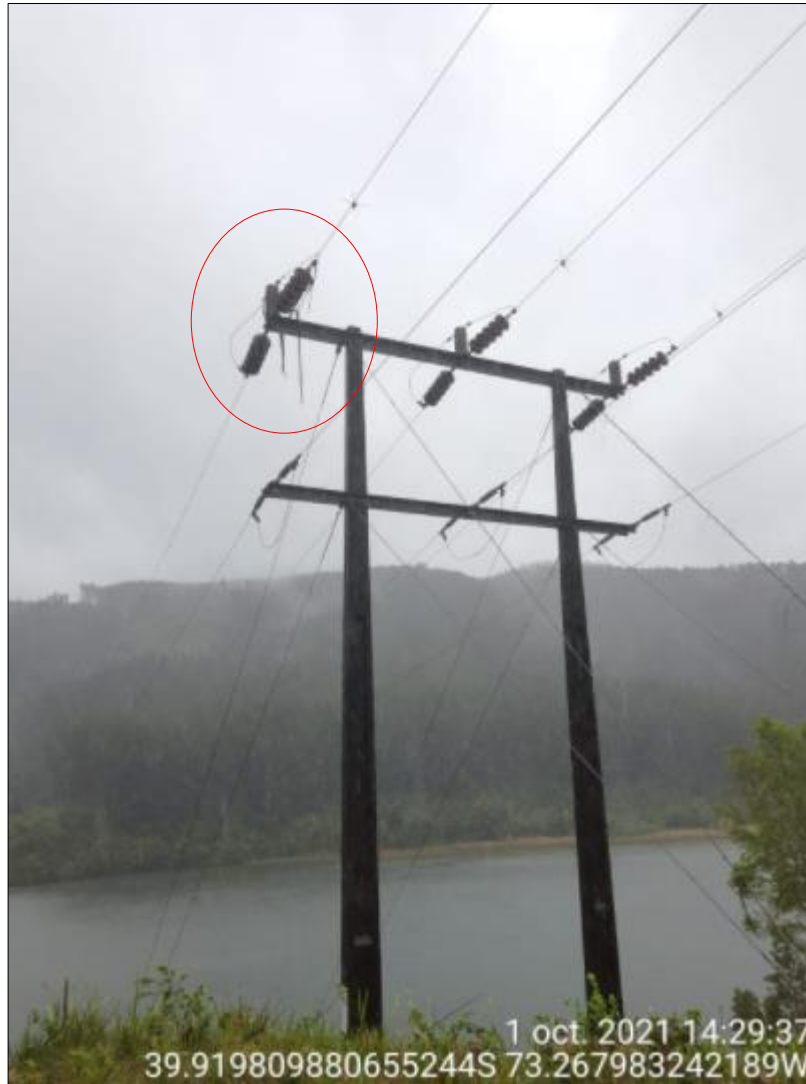
Fotografía 1 se aprecia corteza árbol sobre conjunto de aislación en una de las fases laterales de la línea 66 kV Picarte - Corral.
