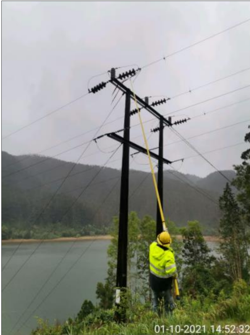
Fotografía 2 se aprecia personal de Mantenimiento realizando despeje de la falla.
