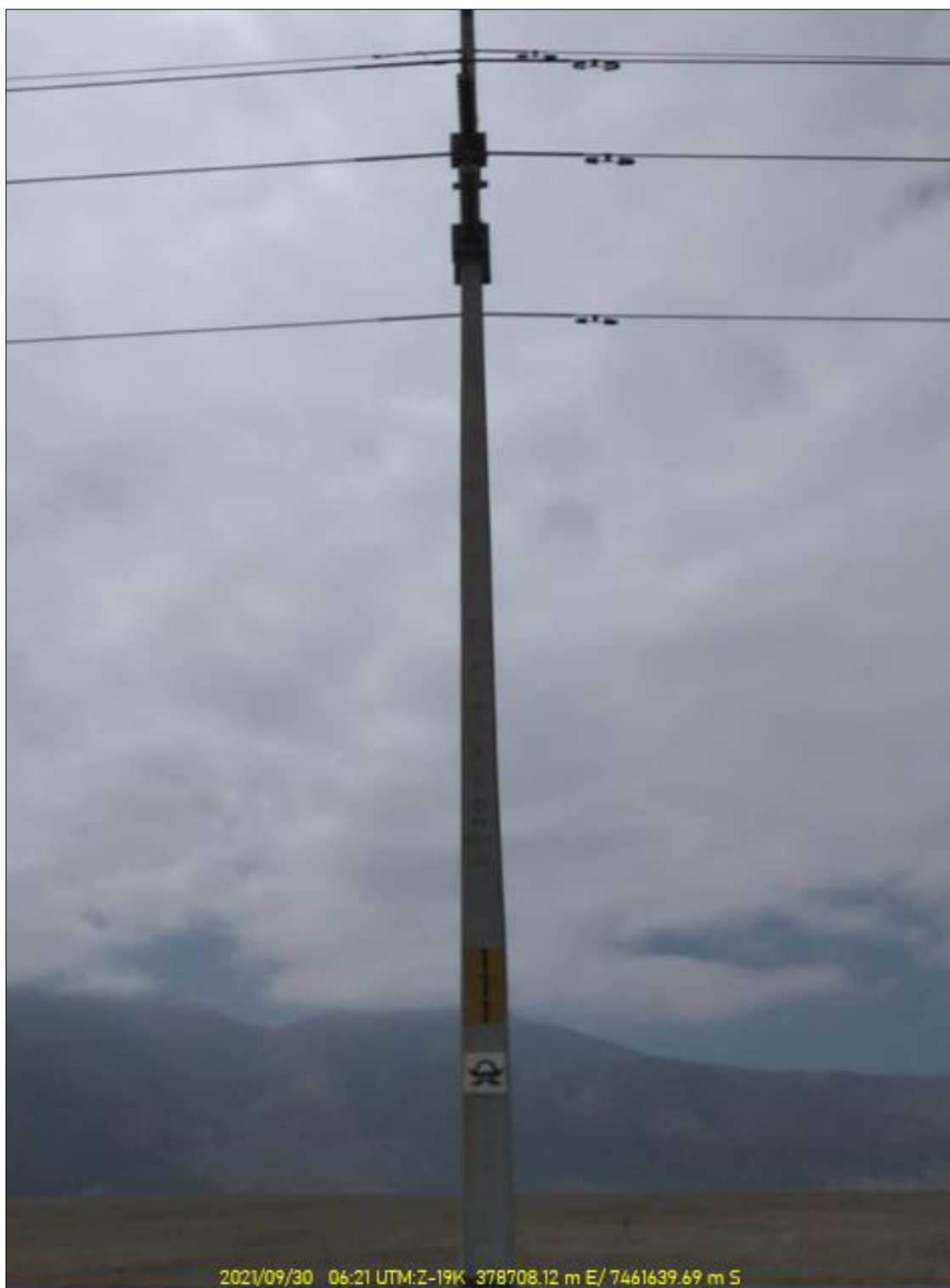
Fotografía 2. Muestra estructura N°111 donde ocurrió el arco eléctrico producido por el ave al acortar distancia con la línea.
