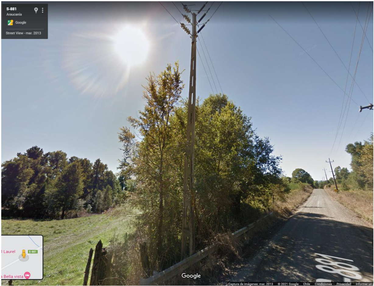
Fotografía N°11. LT 66KV V Villarrica – Pucón. Soporte o barra de contención en Estructura N°394 previo a pavimentación de ruta S-881.
