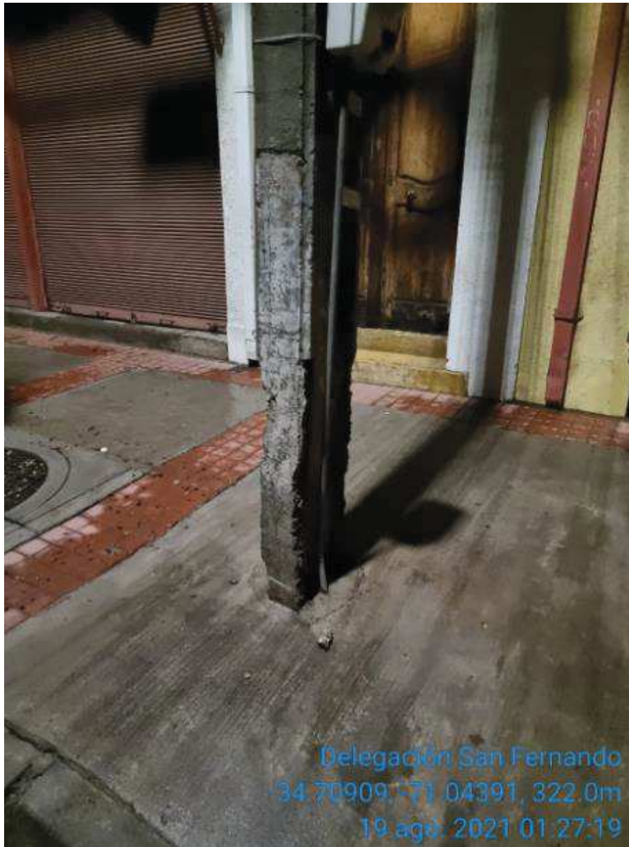
Imagen N°1 Estructura de media tensión asociada a Cto Niebla 52C3 con daño en base por choque de vehículo
