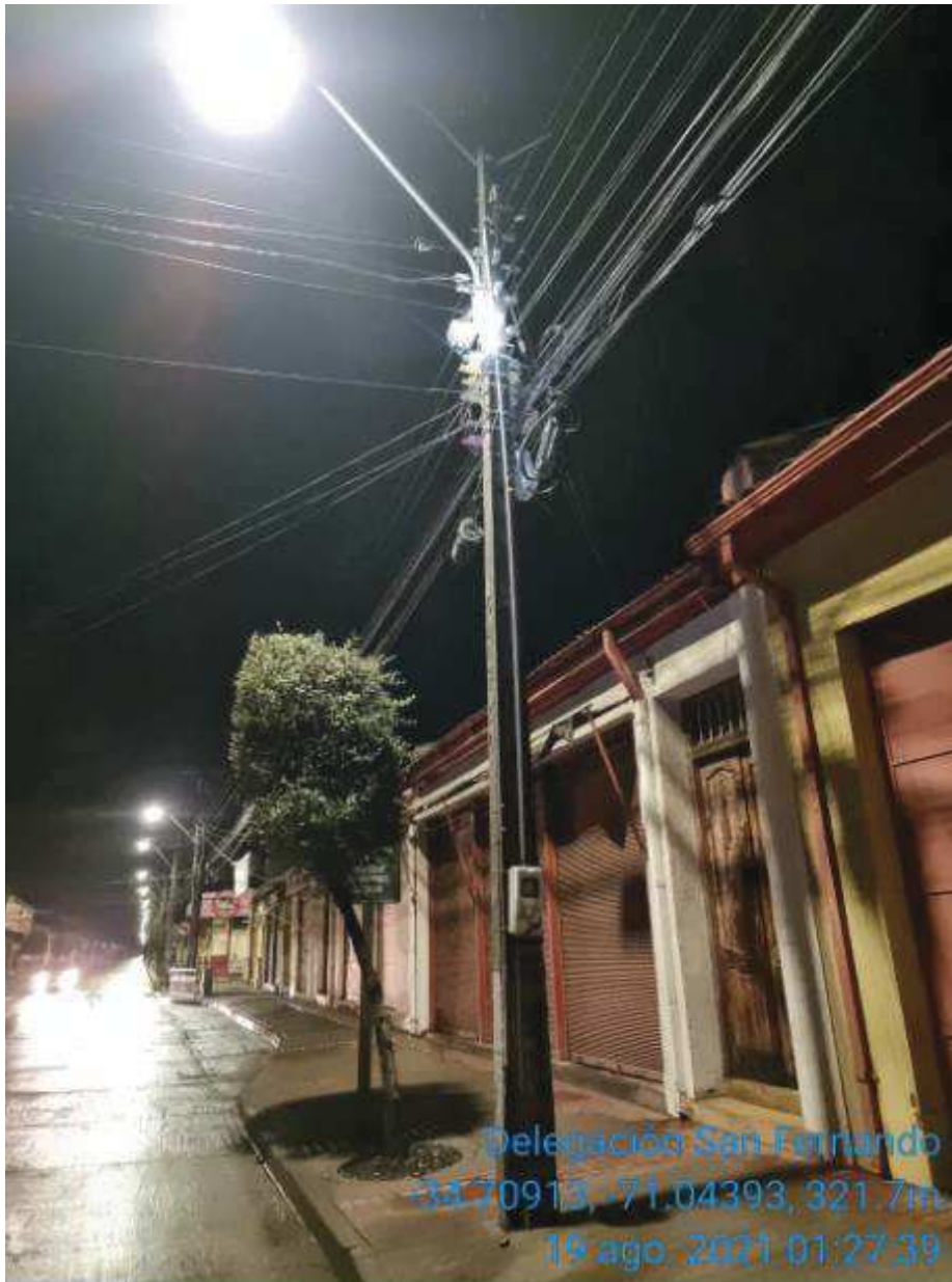
Imagen N°4 Estructura de media tensión asociada a Cto Niebla 52C3 con daño en base por choque de vehículo
