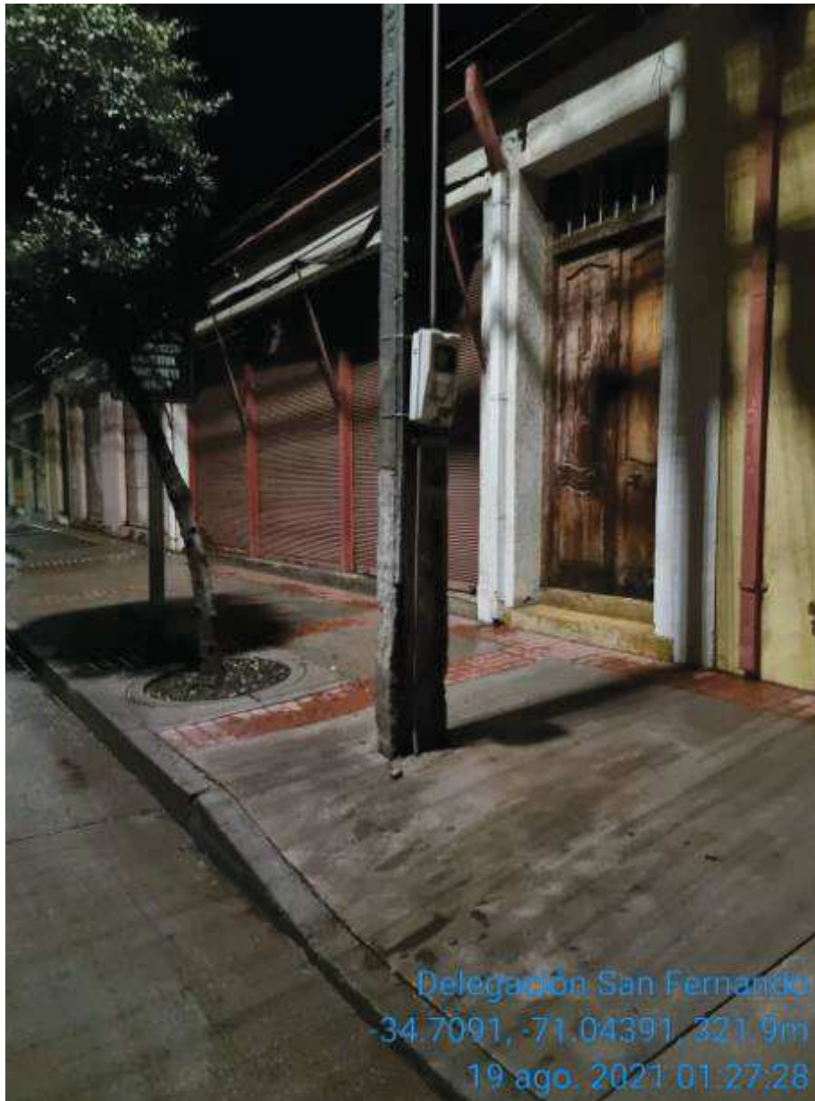
Imagen N°5 Estructura de media tensión asociada a Cto Niebla 52C3 con daño en base por choque de vehículo
