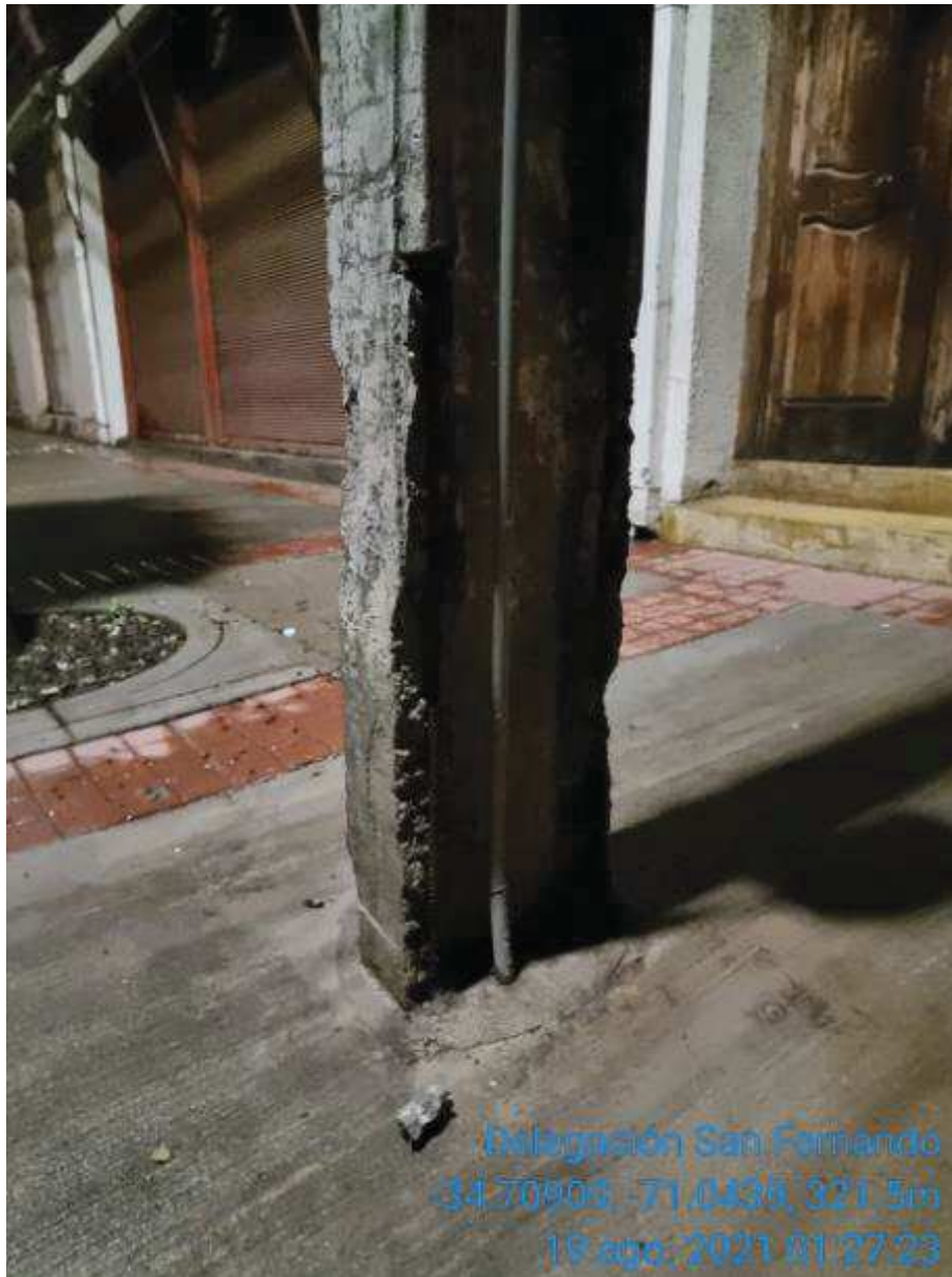
Imagen N°2 Estructura de media tensión asociada a Cto Niebla 52C3 con daño en base por choque de vehículo
