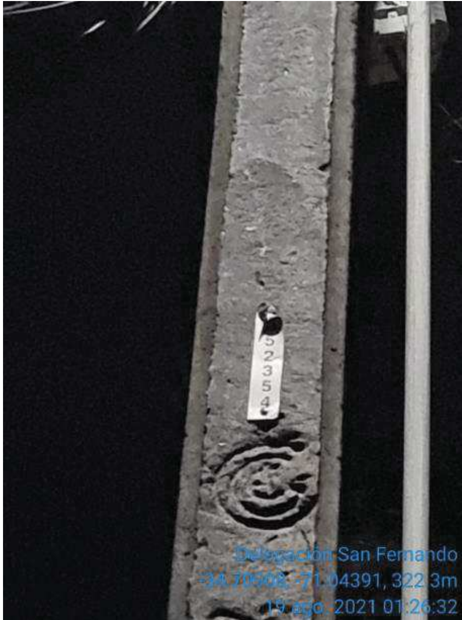
Imagen N°6 Estructura de media tensión asociada a Cto Niebla 52C3 con daño en base por choque de vehículo
