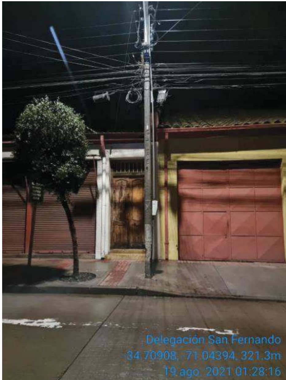
Imagen N°3 Estructura de media tensión asociada a Cto Niebla 52C3 con daño en base por choque de vehículo
