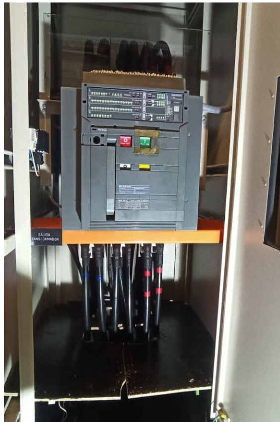
Figura 9.6 – Puntos de instalación TTCC externo
