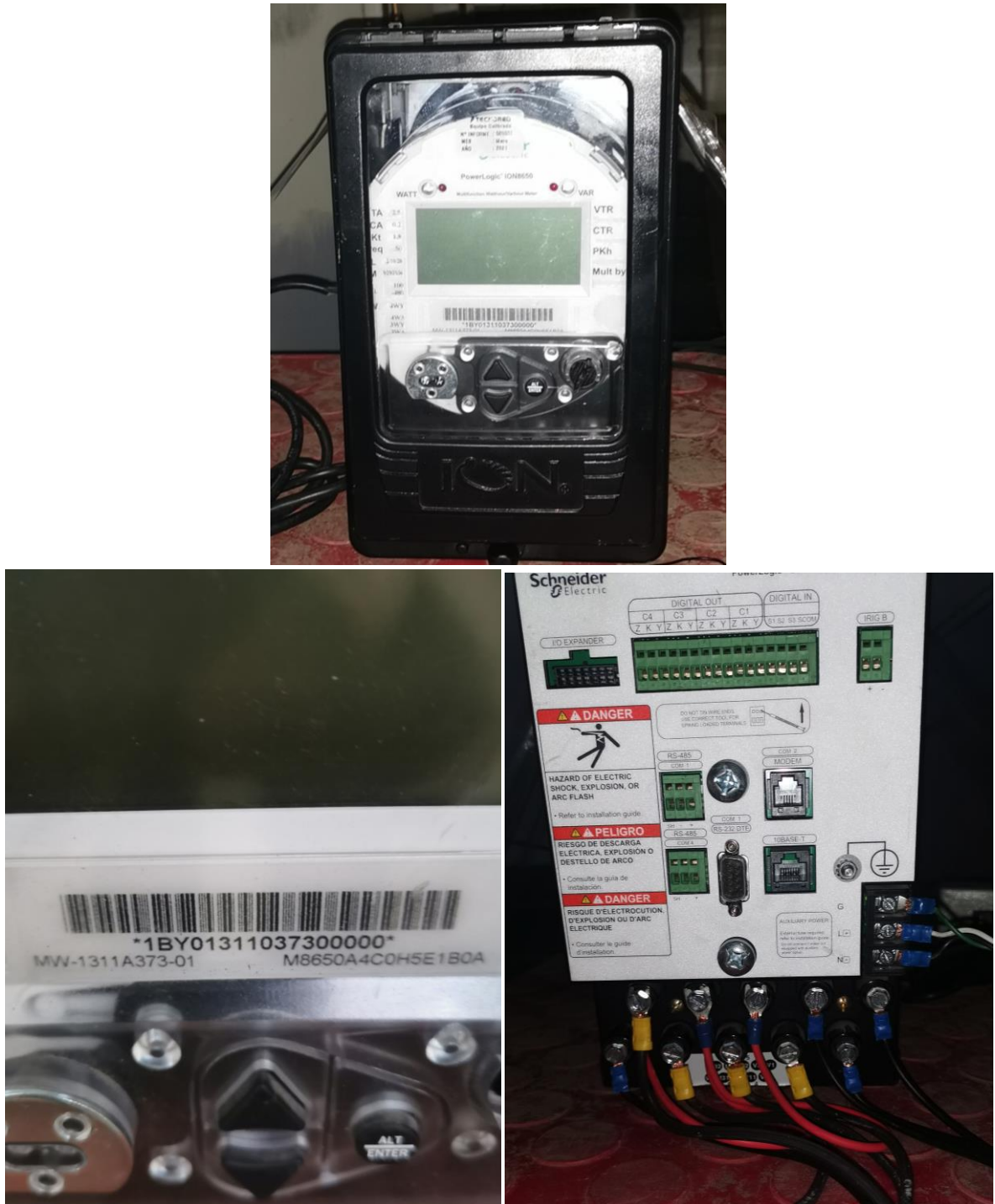
Figura 9.32 – Medidor de potencia bruta/FP unidad G5
