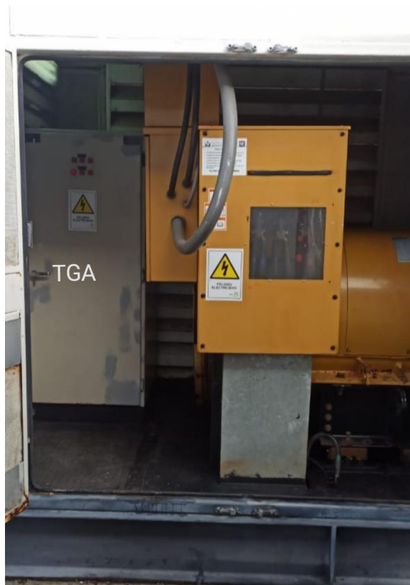
Figura 9.7 – Puntos de instalación TTCC externo
