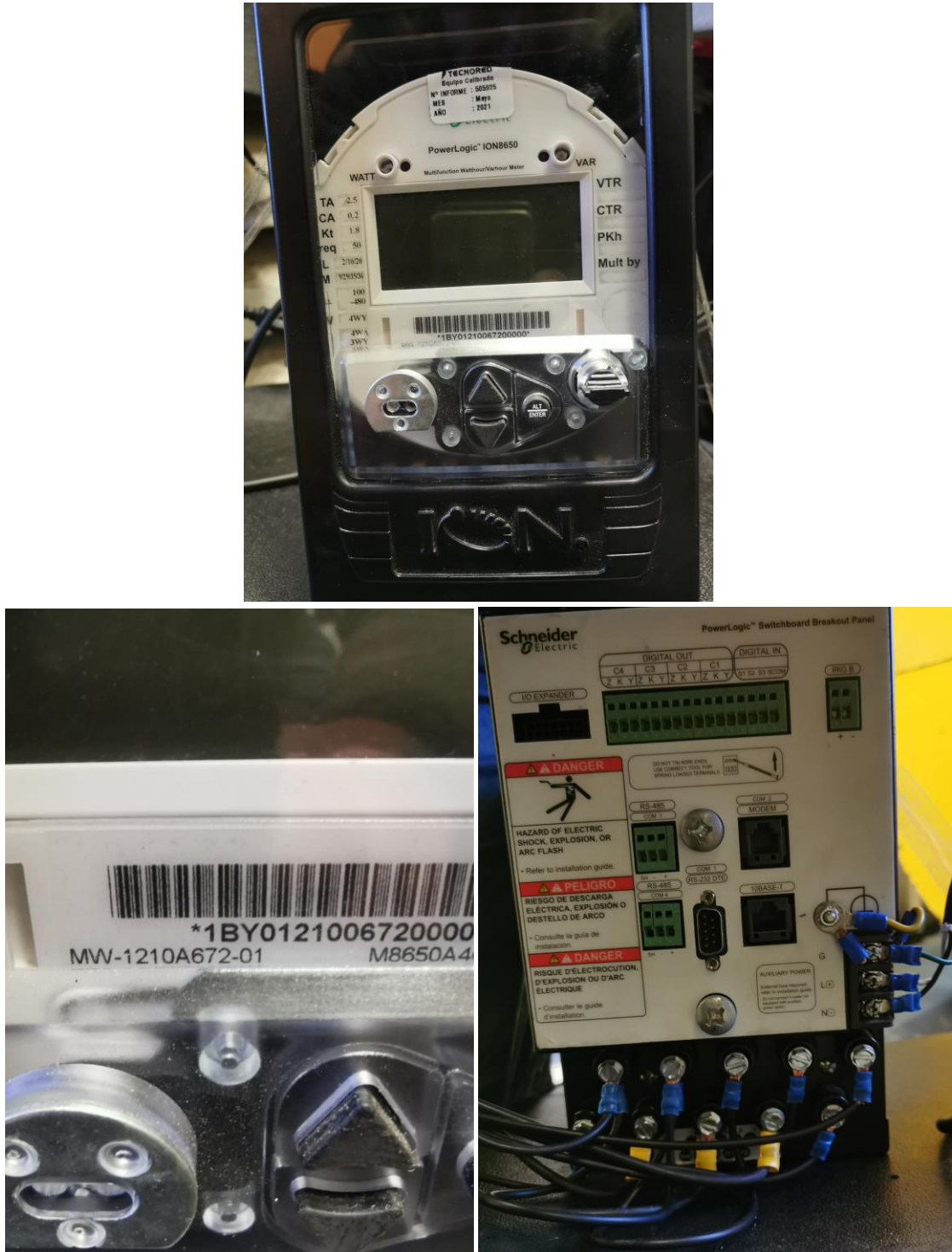
Figura 9.31 – Medidor de potencia bruta/FP unidad G1
