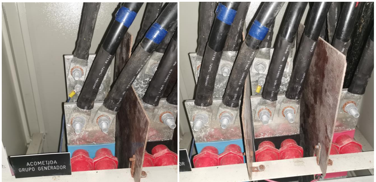
Figura 9.35 – Conexión sobre la barra de 400 V
