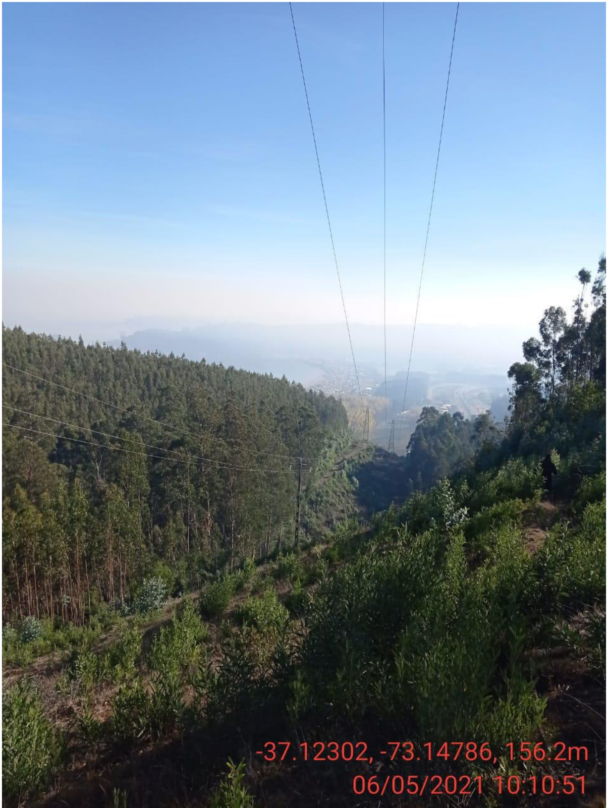
Fotografía Nº 5: Se muestra el correcto despeje de la franja de seguridad de la línea.
