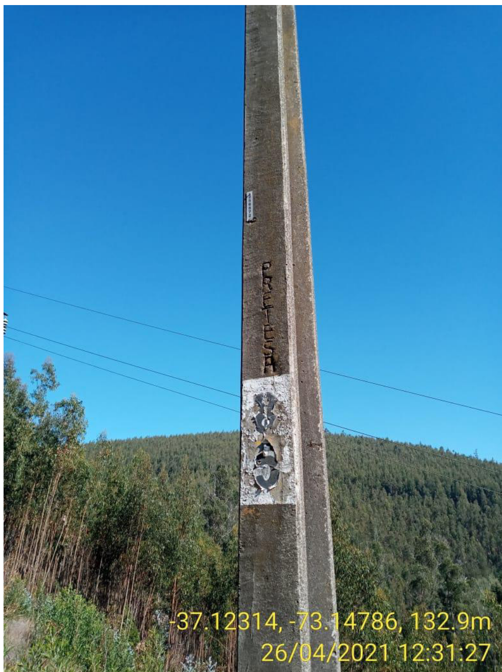
Fotografía Nº 1: Estructura 85 de referencia, instalaciones afectadas por tala no autorizada.
