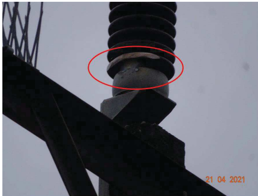
Ilustración 5, MARCAS DE DESCARGA EN BASE DE LINEPOST
