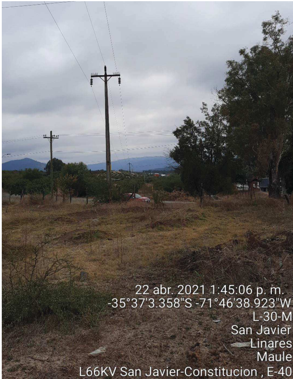
Panorámica del lugar donde se produjo la falla, estructura número 40.
