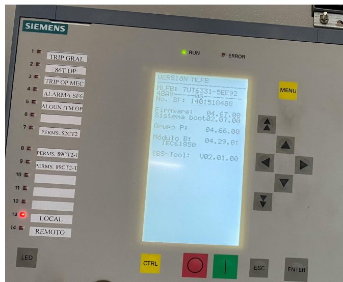
Figura 2. Firmware del relé después de la reinstalación
