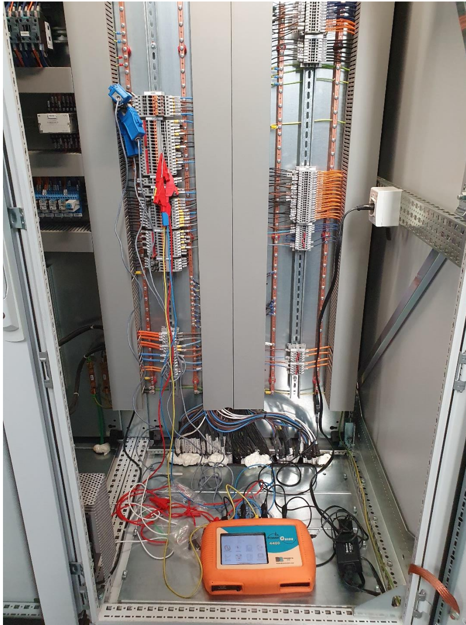
Figura 4.3: Instalación de equipo Dranetz PG4400 en gabinete +2CHA01.
