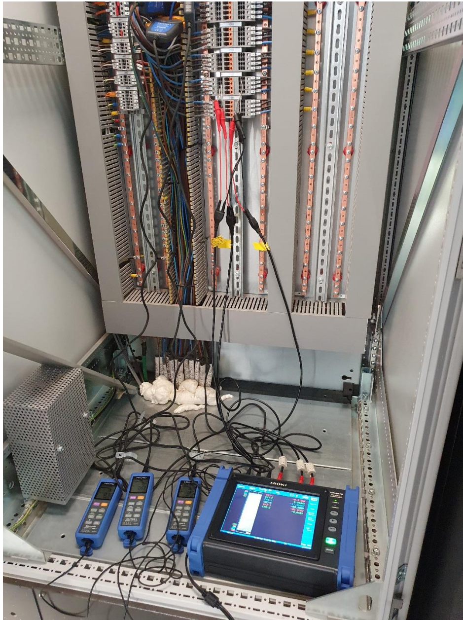
Figura 4.4: Instalación de equipo HIOKI MR875 en gabinete +0CFQ01.
