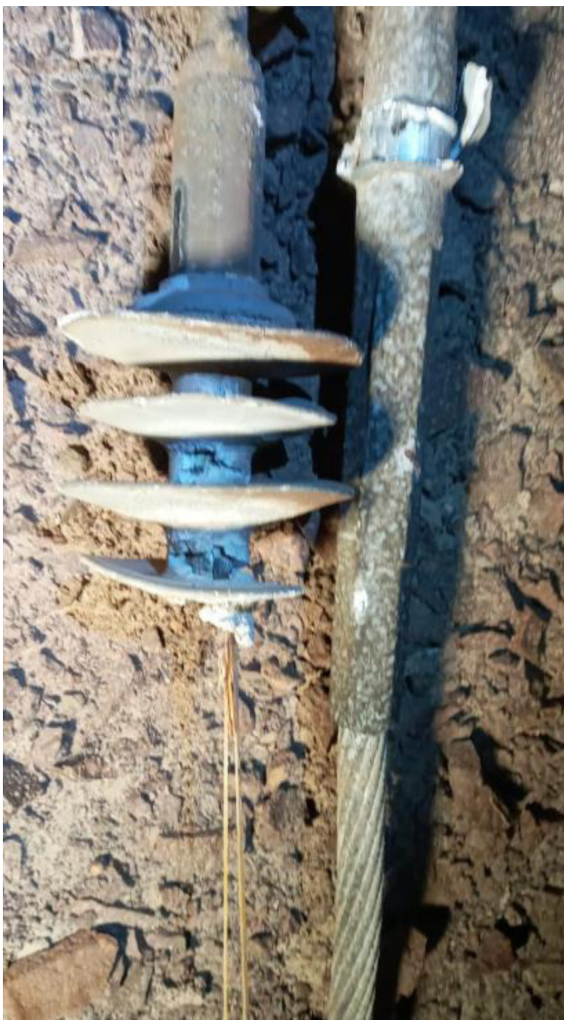
DETALLE AISLADOR POLIMÉRICO CORTADO EST N°16 LT ESMERALDA SUR 110 KV
