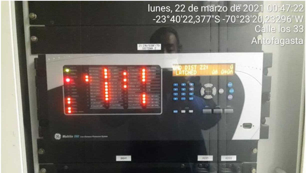
PROTECCION OPERADA GE URD60_H1 SE ESMERALDA
