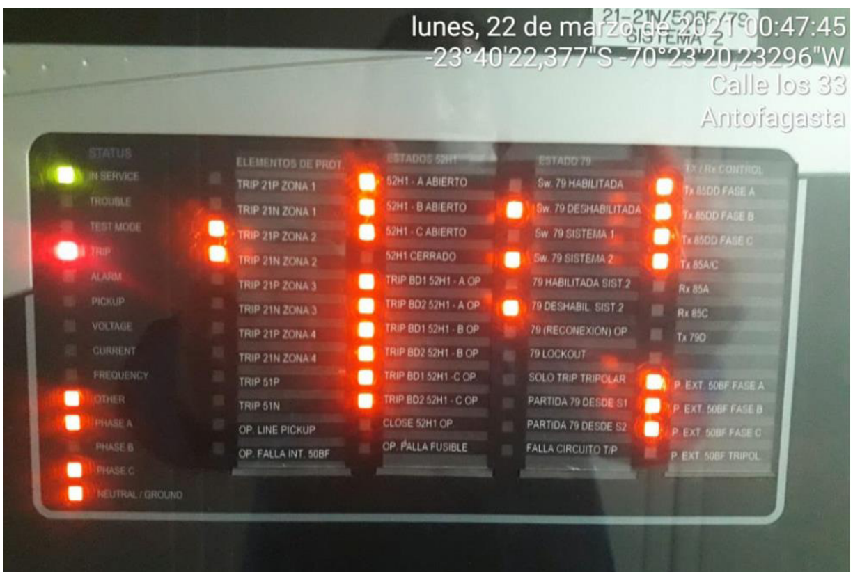
PROTECCION OPERADA GE URD60_H1 SE ESMERALDA
