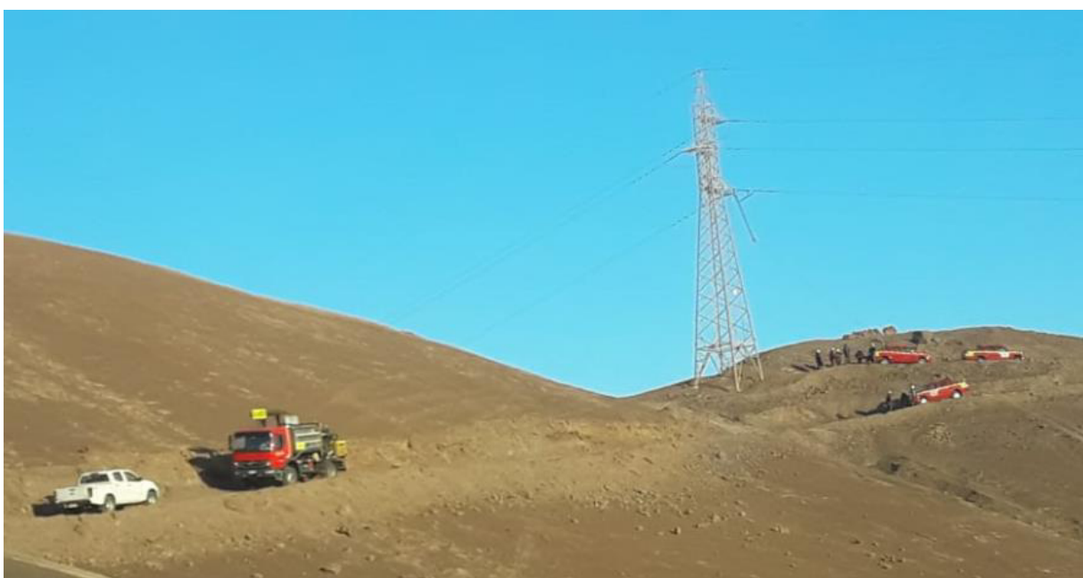
ESTRUCTURA N°16 LINEA ESMERALDA SUR 110 KV DONDE SE PRODUCE CORTE AISLADOR POLIMERICO FASE A
