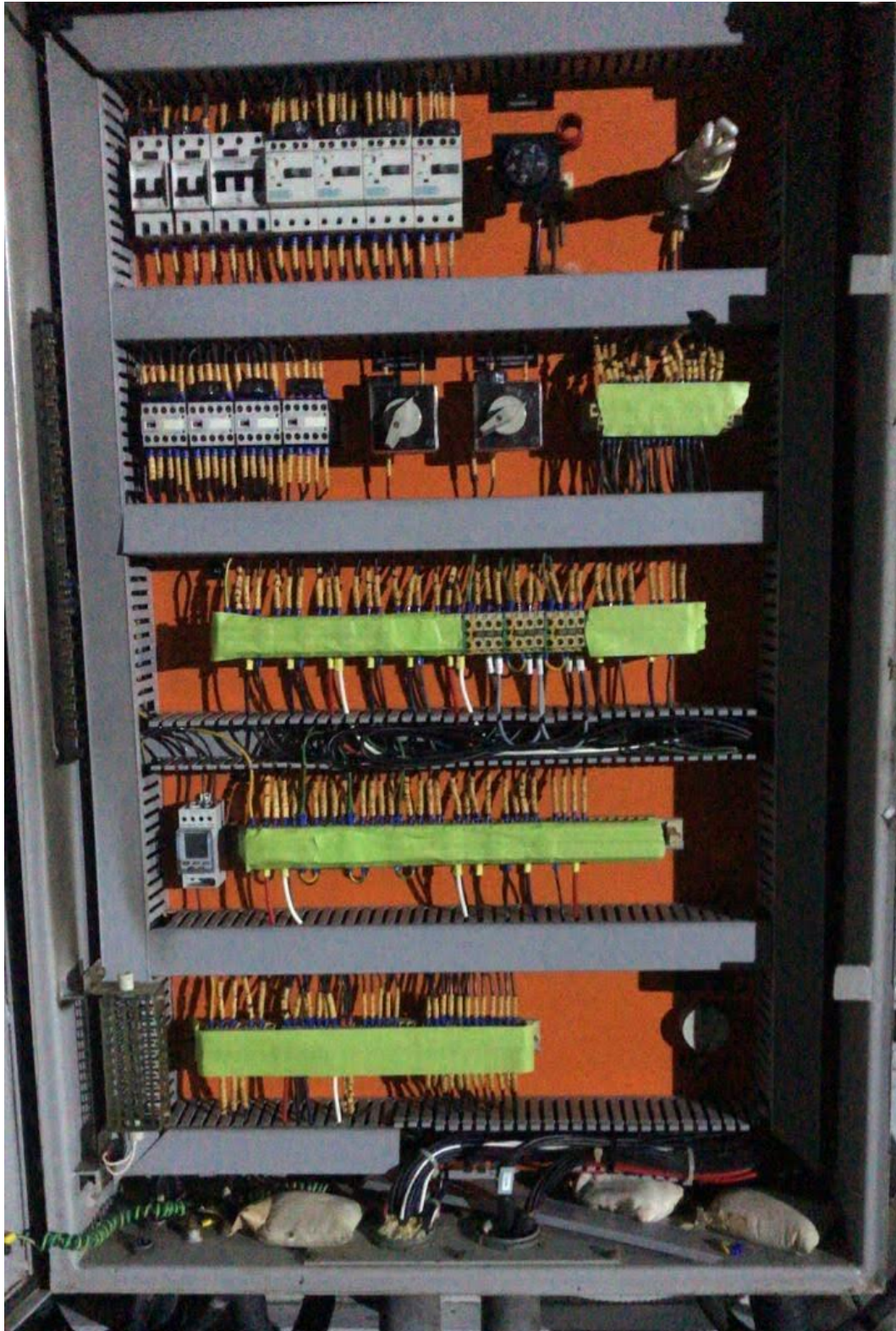
Imagen 1. Punto de trabajo del personal presente en S/E Ancud, gabinete Transformador N°1 110/23 [kV].
