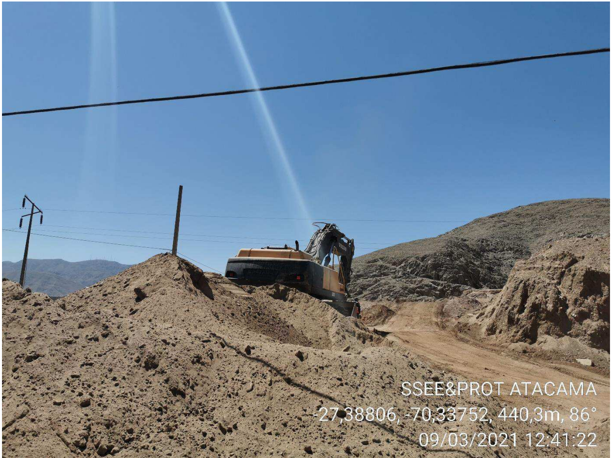
Fotografía N°3 Evidencia demuestra que maquina excavadora estaba realizando faenas cerca de la instalación en servicio e incluso realizo un camino por debajo de la línea en servicio
