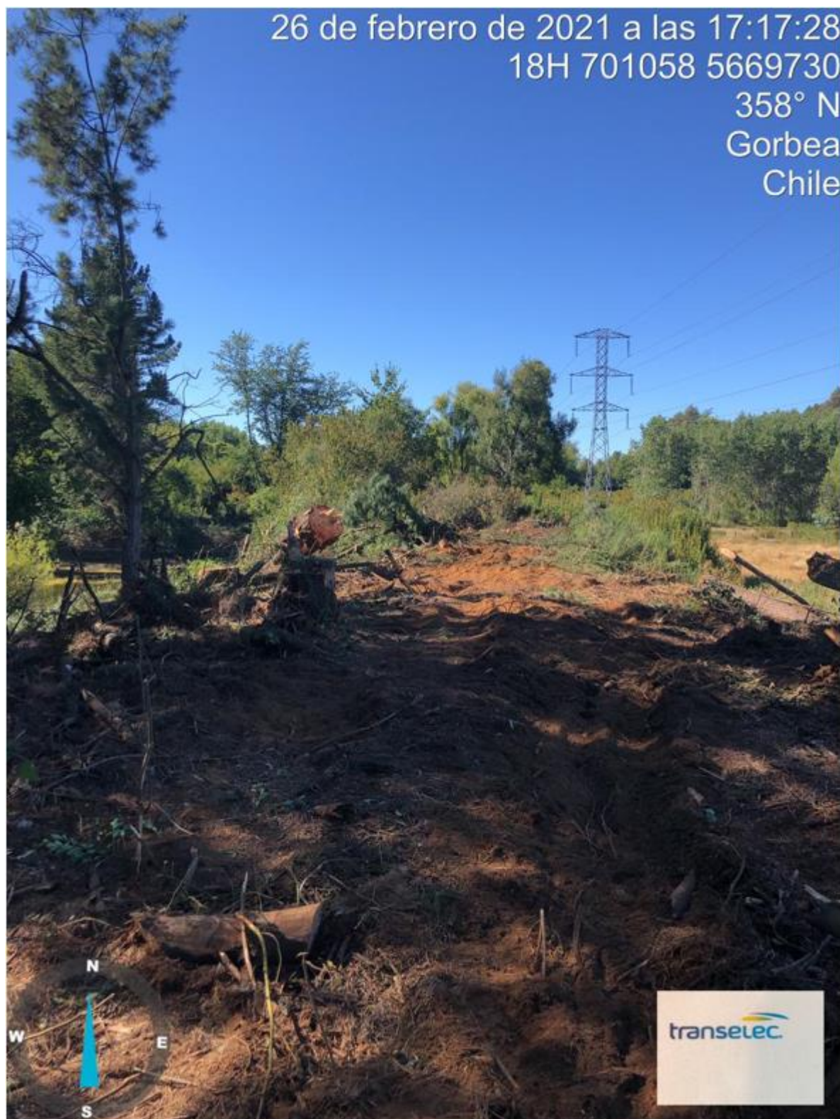
Figura 16: Zona donde se ocasionó la falla. Fuente: Transelec.
