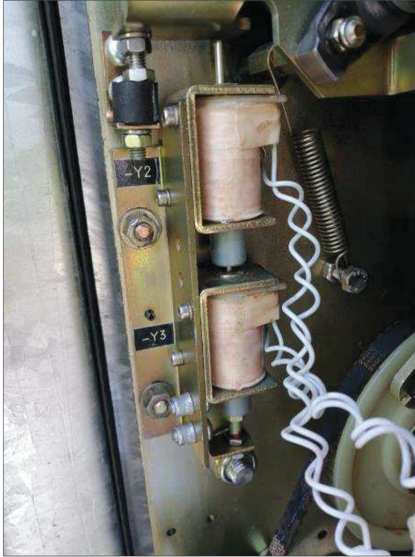
Fotografía N°5. Bobinas de apertura 1 y 2 de repuesto instaladas en 52B3 - SE B. Blanco.
