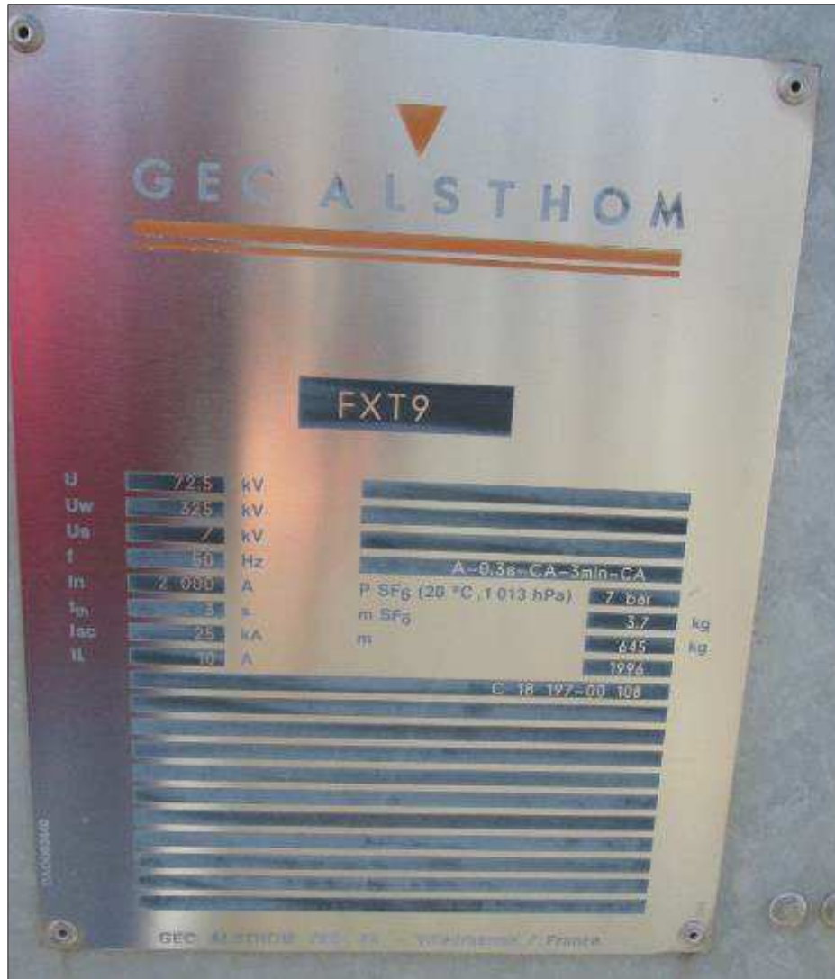
Fotografía N°1. Placa de interruptor 52B3 SE B. Blanco.
