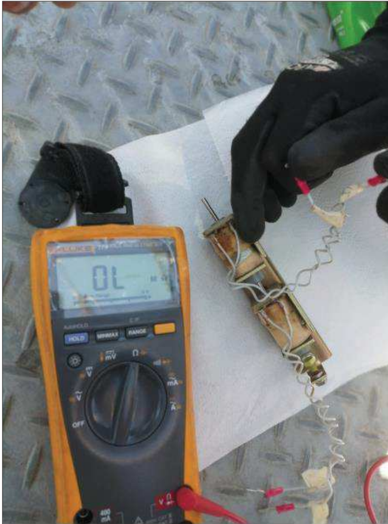
Fotografía N°2. Medición de resistencia óhmica a Bobinas de apertura 1 y 2 originales dañadas - 52B3 - SE B. Blanco.
