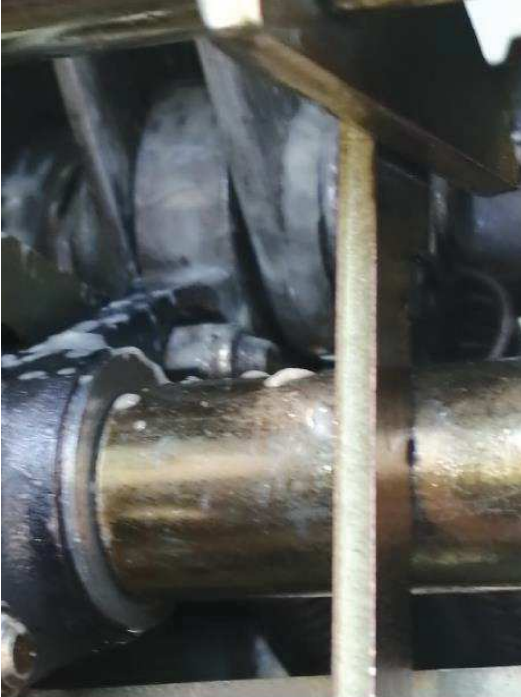
Fotografía N°6. Acercamiento de mecanismo para el desenganche en 52B3 - SE B. Blanco.
