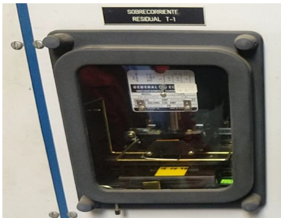
Registro fotográfico, relé electromecánico protección de sobrecorriente residual transformador N°1 S/E Ejército
