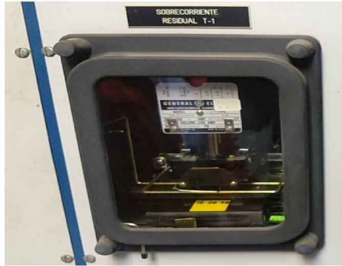
Figura 3. Relé de sobrecorriente GE 12PJC11AV2A asociado a Neutro de Transformador T1, operando sobre relé Maestro de Paño T1 de SE Ejército.
