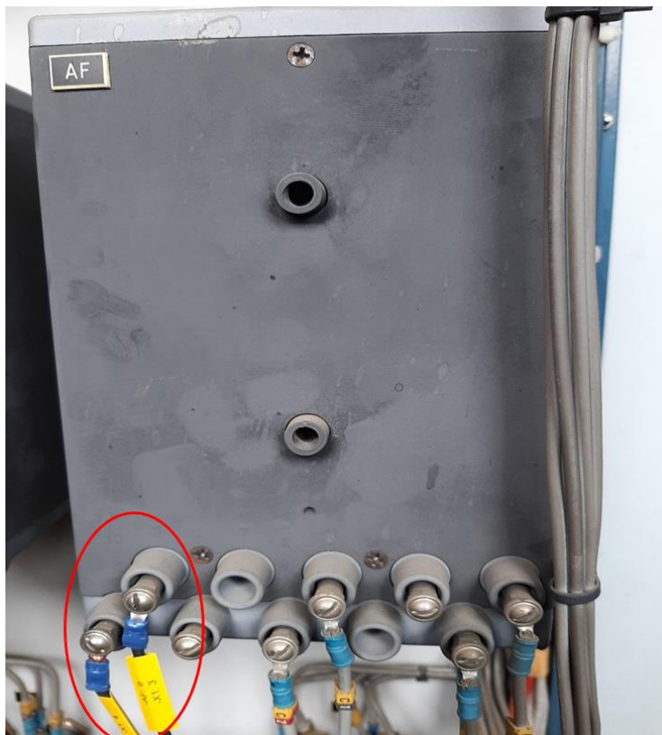
Figura 5; Alambrado de trip, relé Electromecánico GE 12PJC11AV2A Observar Puntos AF9 y AF10.
