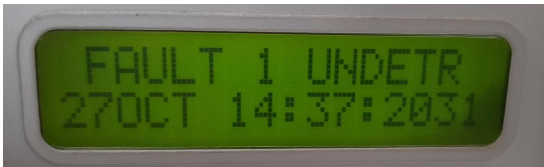
Figura 2: Último registro de falla Relé G.E. DFP 14A1M1110B Paño CT1 SE Ejército.
