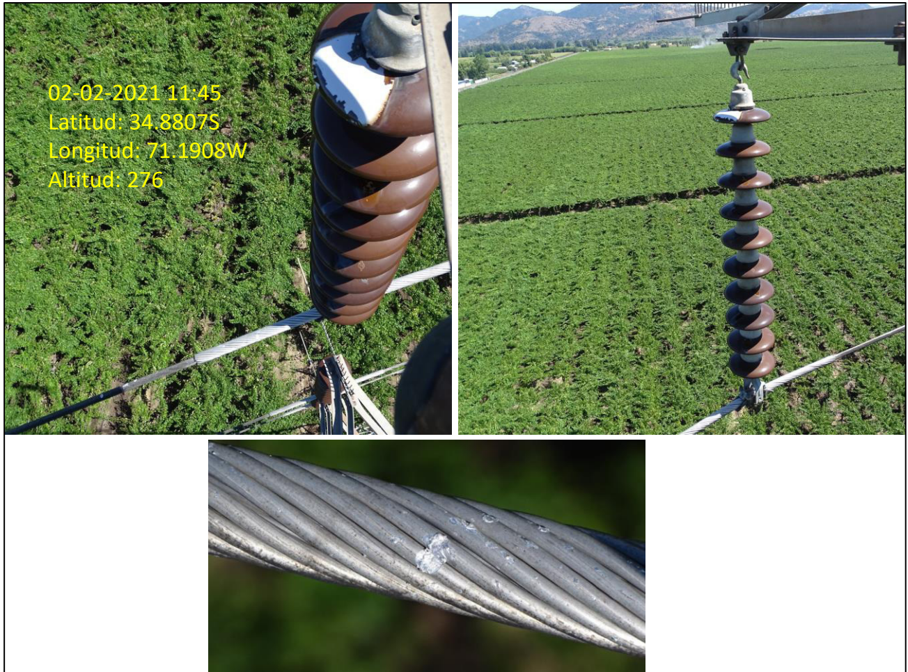
Figura 4-1-1: Registro fotográficos del punto de falla, con fecha, hora y coordenadas UTM.
