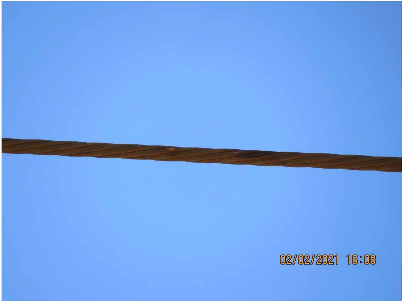
Figura 15: Señal de punto de contacto con acortamiento con camión grúa, fase A. Vano entre estructuras 136 y 137
