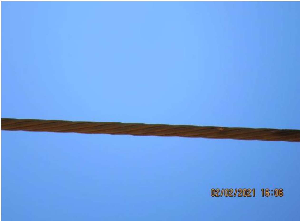
Figura 14: Línea 66kV Pullinque – Los Lagos C1
