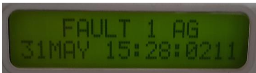
Figura 2: Último registro de falla Relé G.E. DFP 14A1M1110B Paño CT2 SE Ejército.
