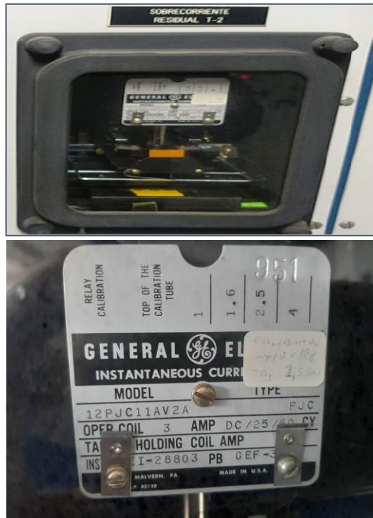
Figura 3. Relé de sobrecorriente GE 12PJC11AV2A asociado a Neutro de Transformador T2, operando sobre relé Maestro de Paño T2 de SE Ejército.
