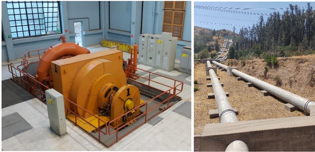
Figura 1: Izquierda: Central Florida II – Unidad 01. Derecha: Tuberías en presión central Florida II.
