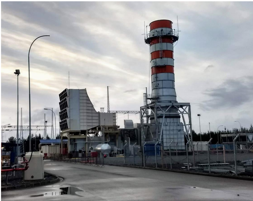
Figura 1. Central Los Guindos, Unidad 02.
