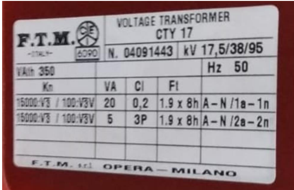
Figura 9.4 – Datos de placa del transformador de tensión para medición de potencia bruta
