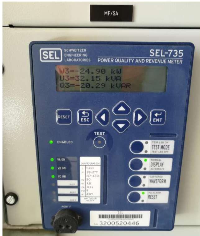
Figura 0-3 Registro 3 Potencia activa SSAA
