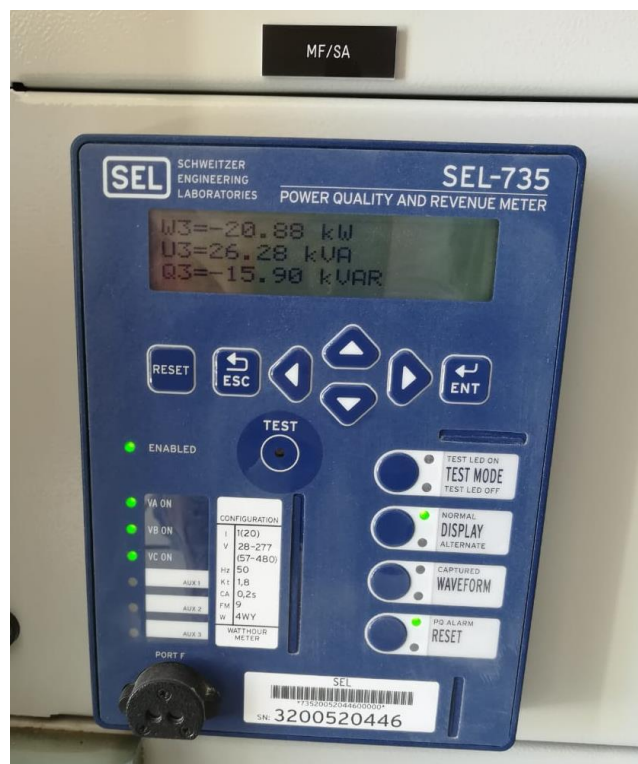
Figura 0-2 Registro 2 Potencia activa SSAA
