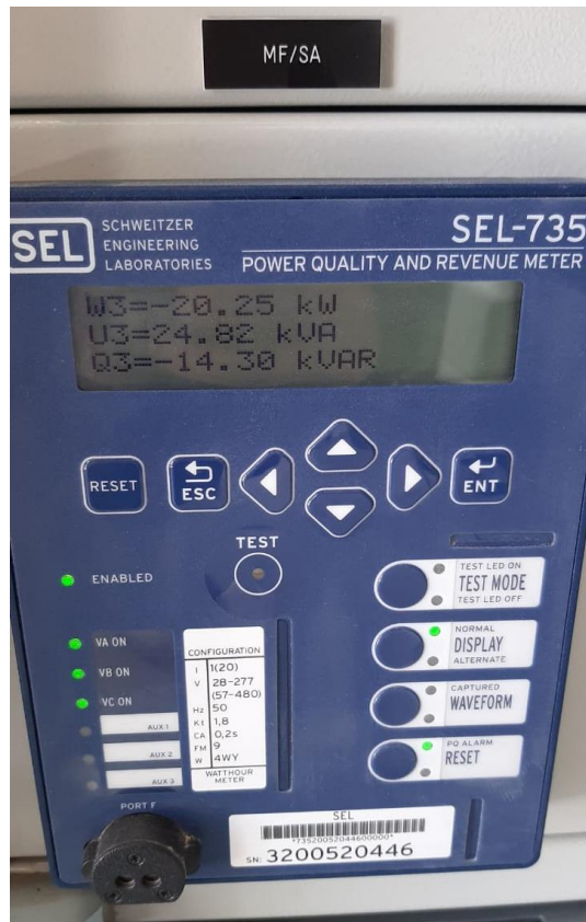
Figura 0-6 Registro 6 Potencia activa SSAA
