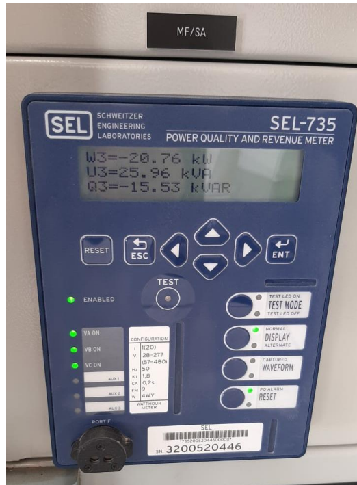
Figura 0-5 Registro 5 Potencia activa SSAA
