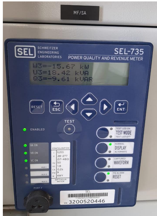
Figura 0-1 Registro 1 Potencia activa SSAA
