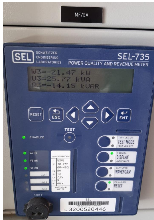
Figura 0-4 Registro 4 Potencia activa SSAA
